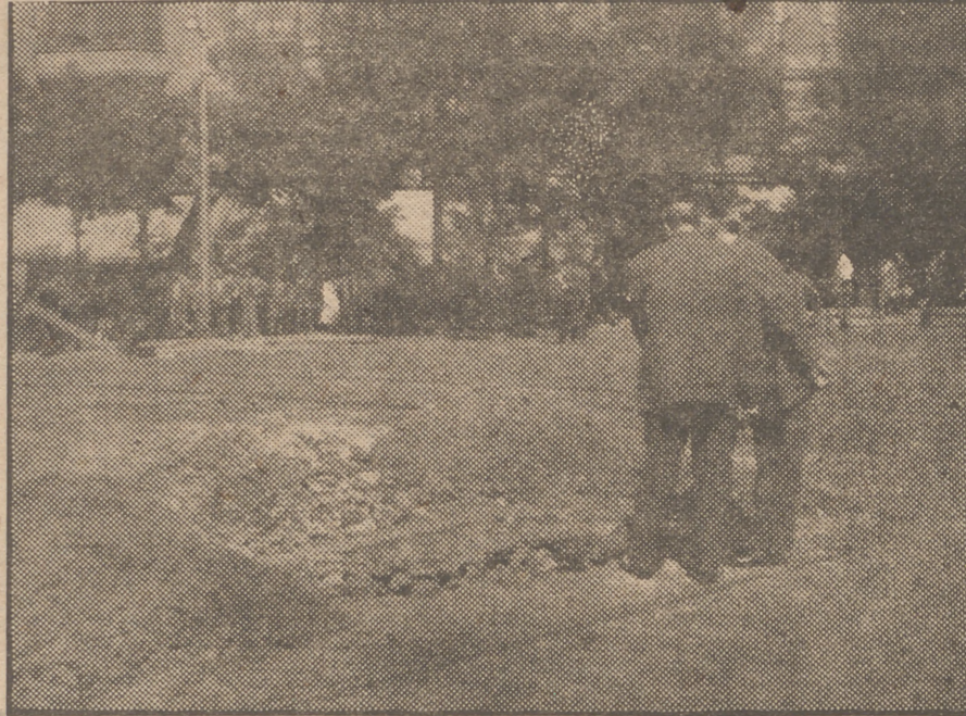
La avería surgida esta madrugada en las conducciones de aguas del Canal de Isabel II produjo este tremendo socavón en la plaza de Chamberí, obligando a interrumpir el tránsito de vehículos y peatones. Los técnicos y las autoridades municipales procedieron a personarse en el referido lugar, donde fué muy grande la afluencia de curiosos. (Foto Ruiz.)
