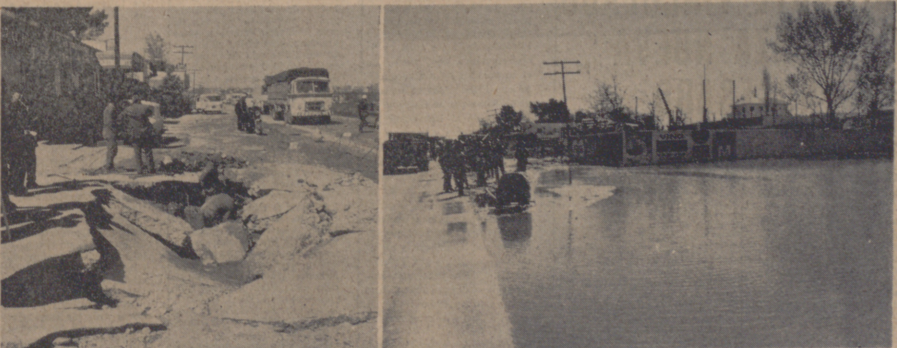
MADRID.—A la altura del kilómetro 12 de la carretera Madrid-Barcelona se produjo la rotura de una cañería principal de agua que ocasionó un gran socavón, una enorme laguna, y fue causa importante en los atascos de tráfico producidos en la dirección hacia el aeropuerto de Barajas y las zonas industriales de Torrejón y Alcalá de Henares. Muchas personas que debían haber viajado en avión hacia distintos puntos se quedaron en el atasco. Y lo mismo sucedió con algunas tripulaciones. Total, muchas pérdidas para las compañías aéreas.—(Foto Cifra Gráfica.)
