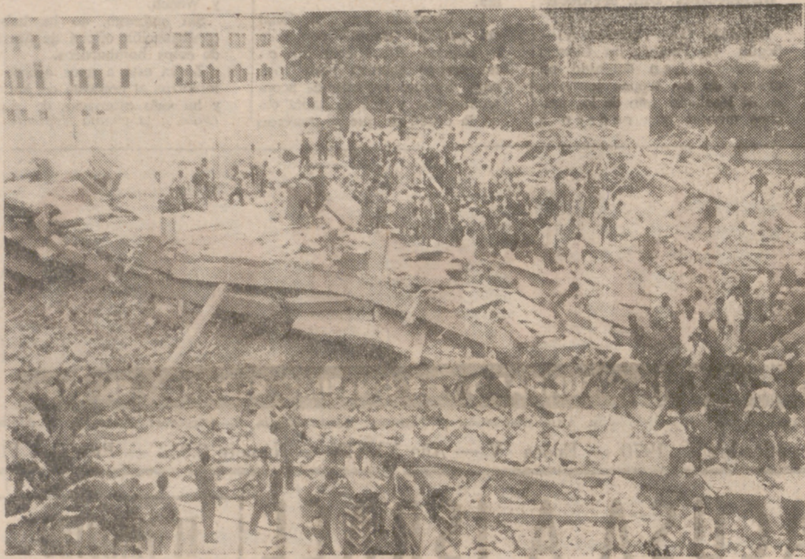
ALMERIA.—Aspecto del hundimiento de la casa en construcción, de diez pisos, en la calle Hermanos Pinzón, de esta capital. Unos treinta obreros quedaron enterrados entre los escombros. Fueron rescatados con vida cinco obreros, se extrajeron cuatro cadáveres y se sabe que existe alguno más con vida, pero atrapado entre las vigas. —(Foto Cifra Gráfica.)
