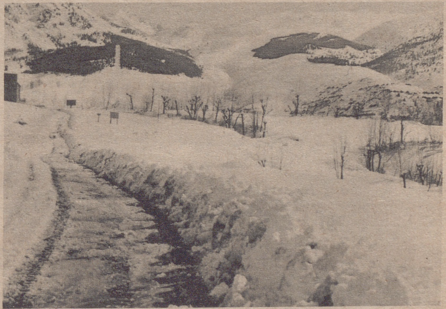
Las obras en la carretera Benasque-Cerler avanzan a buen ritmo. Al fondo de la fotografía pueden apreciarse las soberbias pistas de esquí de Cerler, en parte de las cuales podrá esquiar a partir del día 26. (Foto Ed. SICILIA)
