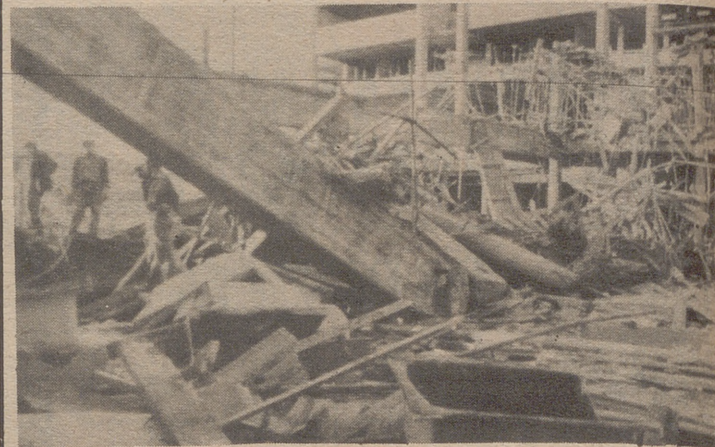
BILBAO. — 90 metros de pasarela se han desplomado en las obras de la nueva universidad de Bilbao. Cinco personas resultaron heridas y otra desaparecida, que se teme se encuentre entre los escombros. (Foto Europa Press).
