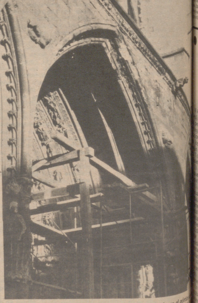
La fotografía nos muestra las obras que están realizando en el pórtico de la catedral de León, a consecuencia de la caída de algunas de las piedras que componen este bello pórtico.
