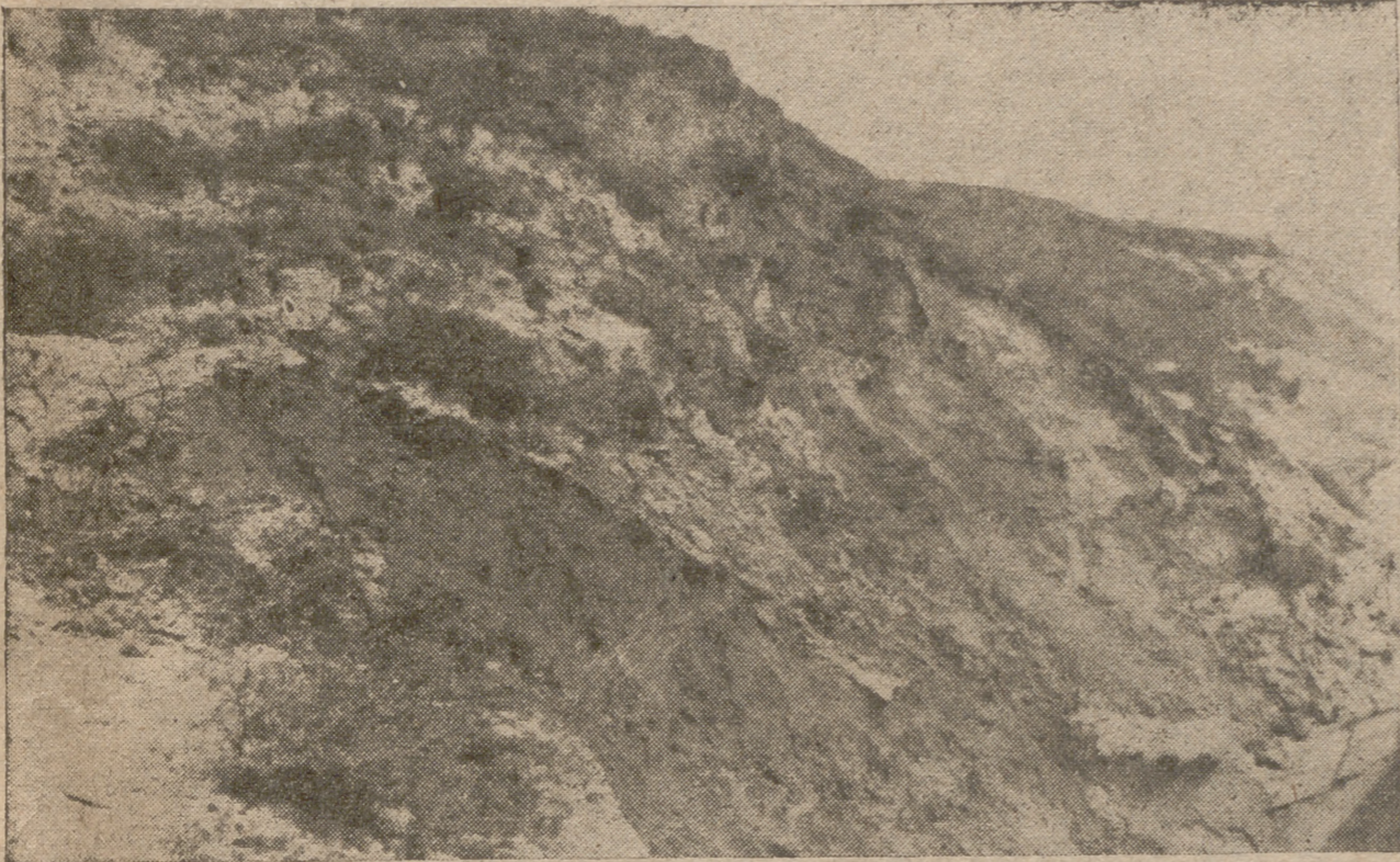
Puede apreciarse en la fotografía el corrimiento del viernes, viéndose las grietas que en el terreno se originan antes de descender por la ladera.
