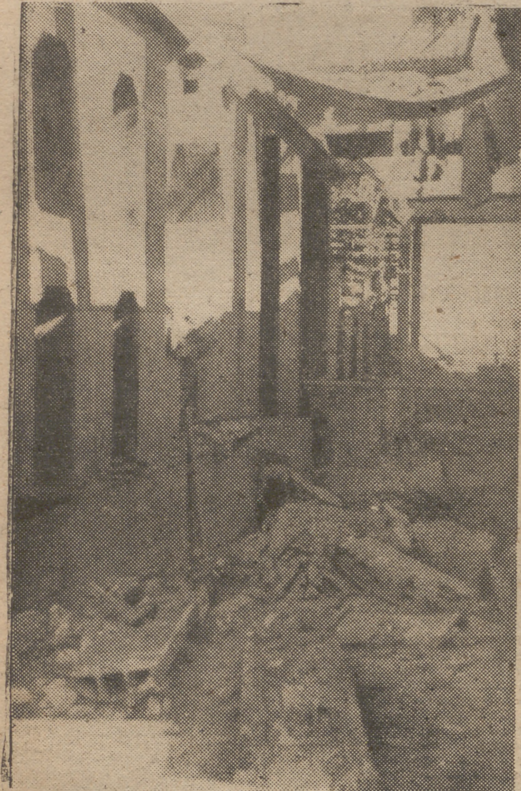
SE DESPLOMO EL TECHO Estado en que quedó la central térmica de Cádiz al desplomarse el techo y sepultar a varios obreros, que hubieron de ser extraídos de entre los escombros en una aparatosa tarea de socorro. (Foto Tremocha.)
