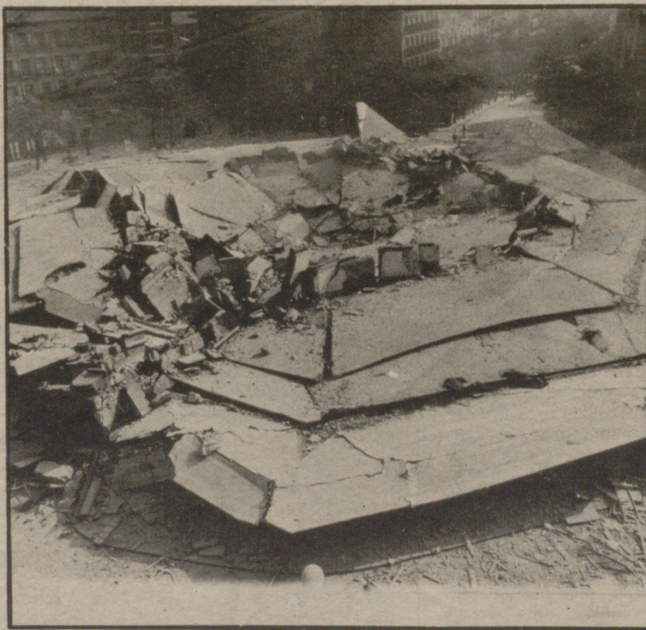
MADRID.— El popular mercado de abastos de Olavide ha sido volado. La explosión ha durado dos segundos, tiempo en el que vinieron al suelo los 12.000 metros cúbicos de escombros. Dicho edificio se hallaba levantado sobre una superficie de 3.000 metros y han sido empleados 5.500 barrenos colocados en los puntos clave de su estructura y dieciocho detonadores. Dicho mercado ha venido funcionando durante poco más de cuarenta años. (Cifra Gráfica).
