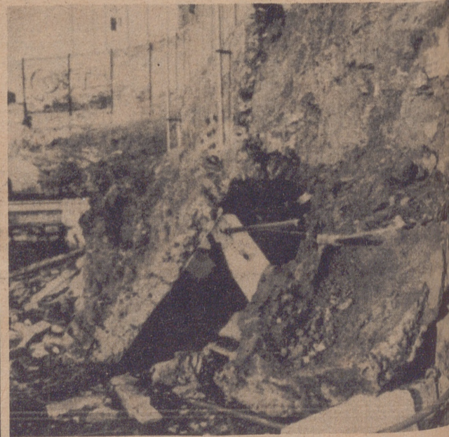
BARCELONA.- Un muro de contención de tierras se ha derrumbado el campo de deportes del Pujollet, debido a las recientes lluvias. Se arrastró parte de las gradas, por lo que la junta Directiva del Manresa ha dispuesto su rápida retirada para poder jugarse el partido del próximo domingo. (Foto Europa)
