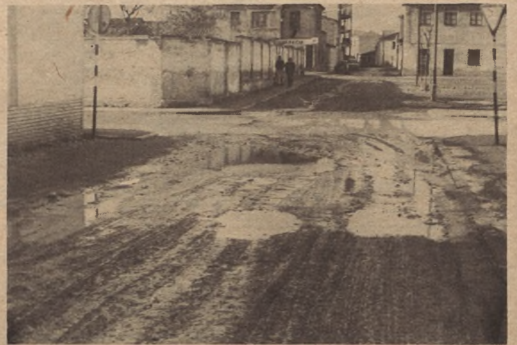
Calle Galicia, confluencia con Plaza de España. Observen el tamaño del bache que existe en el centro de la foto. Sin aceras, sin nada... ¡Madre!
