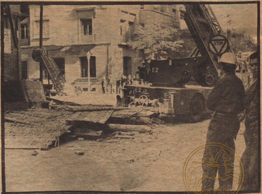
Sobre la calle del Doctor Casas cayó la mayor parte del cañizo y a mediodía seguía cortada al tráfico. Gran número de curiosos se concentraron en las inmediaciones.
