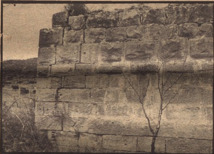
Parte de uno de los ángulos frontales, con sillares almohadillados del destruido dique romano en Cinco Villas.
