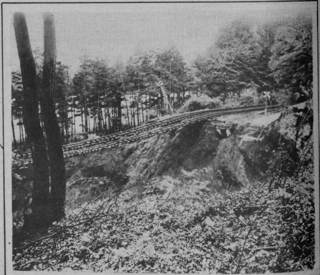
En Vinenburg (Alemania), las lluvias torrenciales inutilizaron un trozo de vía, motivando un descarrilamiento del que resultaron numerosas víctimas. He aquí cómo quedó la vía después de la avenida que interceptó la circulación ferroviaria. — (Fot. Scherl)
