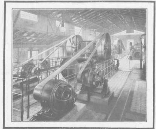
Central eléctrica de Oranienburg. 3 semifijas WOLF, en junto 414 HP.
