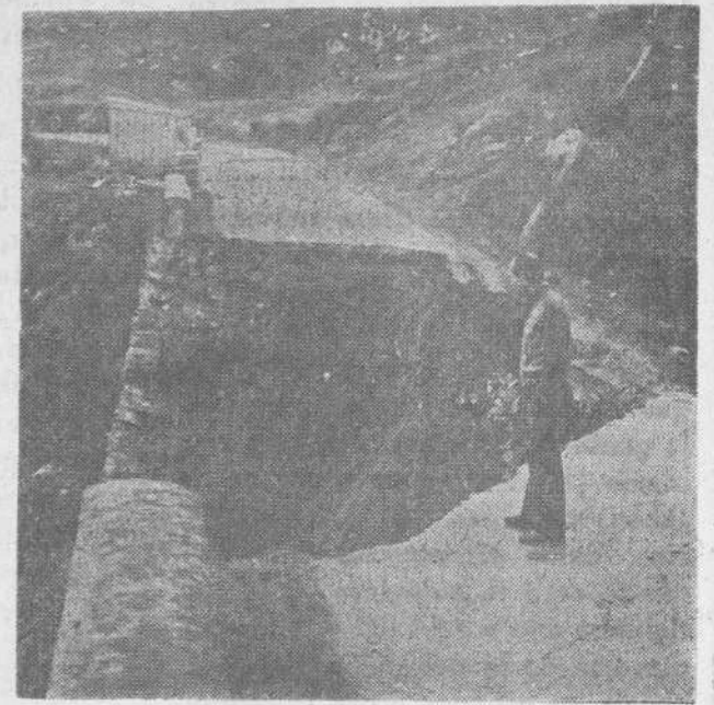
¿Hasta cuándo va a seguir cortada esta carretera de Santillana del Mar a Ubiarco? Las obras están paradas hace mucho tiempo y no se reanudan. (Foto A. B. E.)
