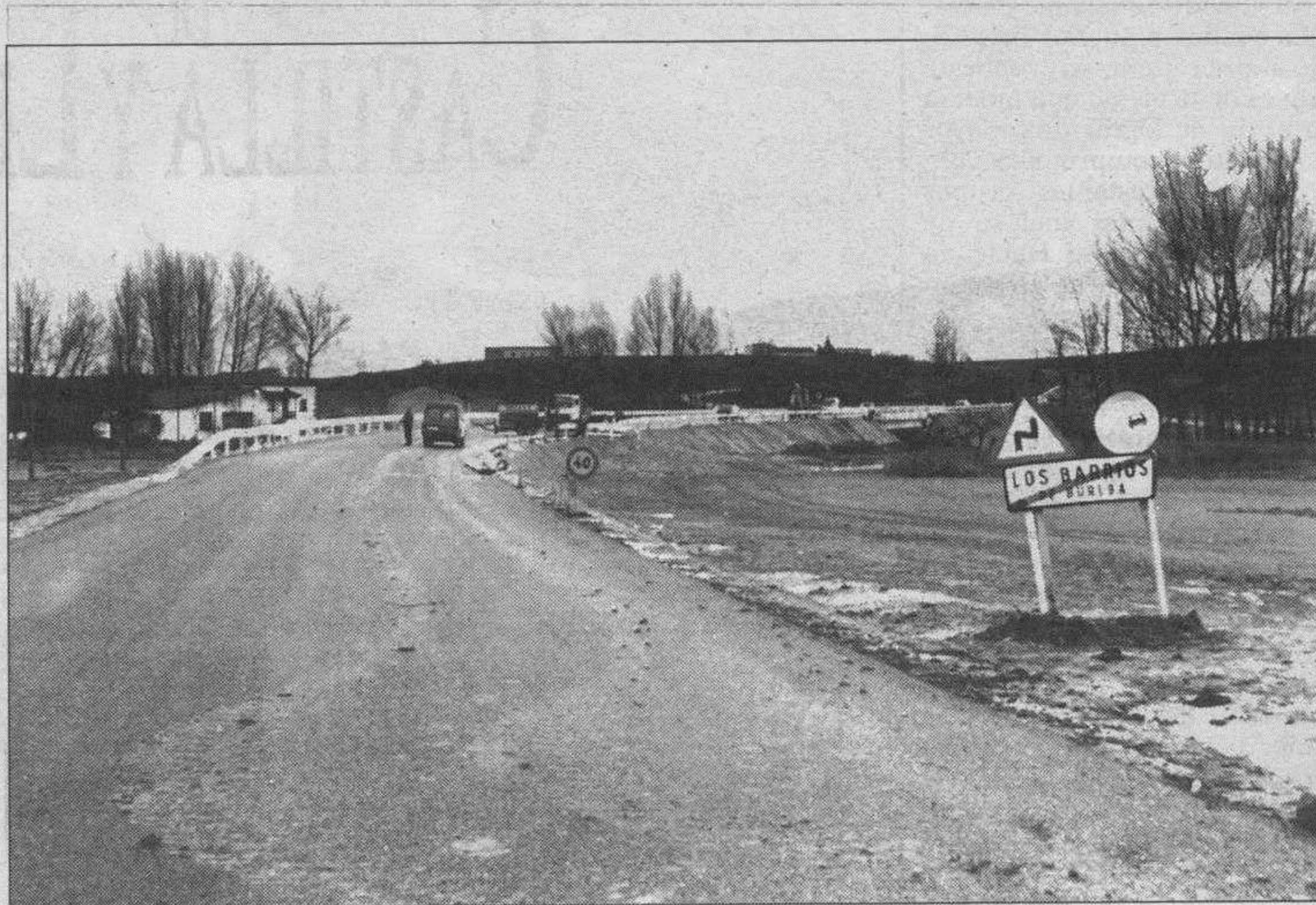
Con la apertura del nuevo puente y variante de Los Barrios de Bureba finalizan las obras.
