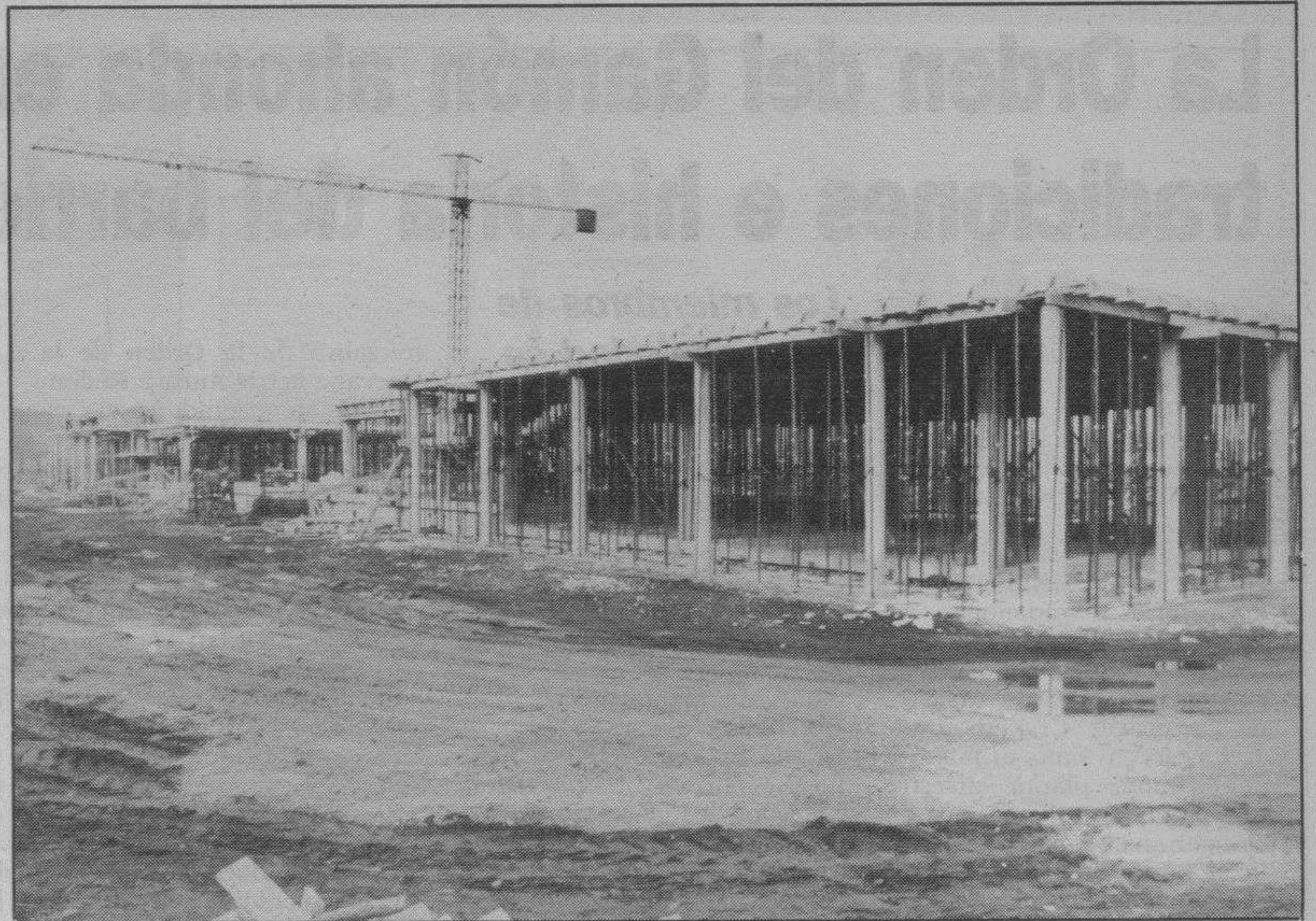
Las obras de construcción de nuevo centro comenzaron hace tres meses. (Foto: L. Matías).
