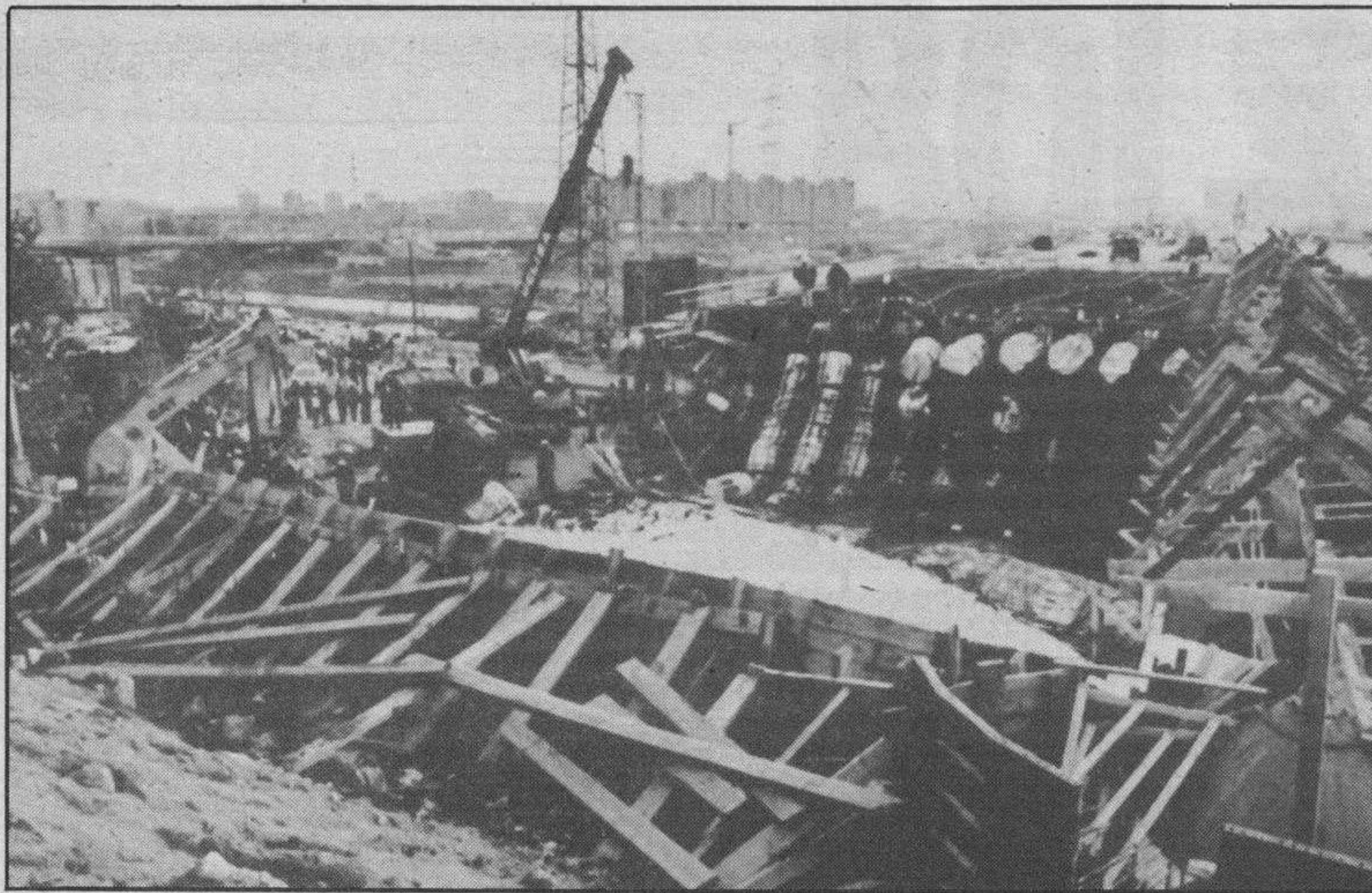
Estado del puente sobre el Besós tras el derrumbamiento que ocasionó cinco heridos. (F.: Efe).
