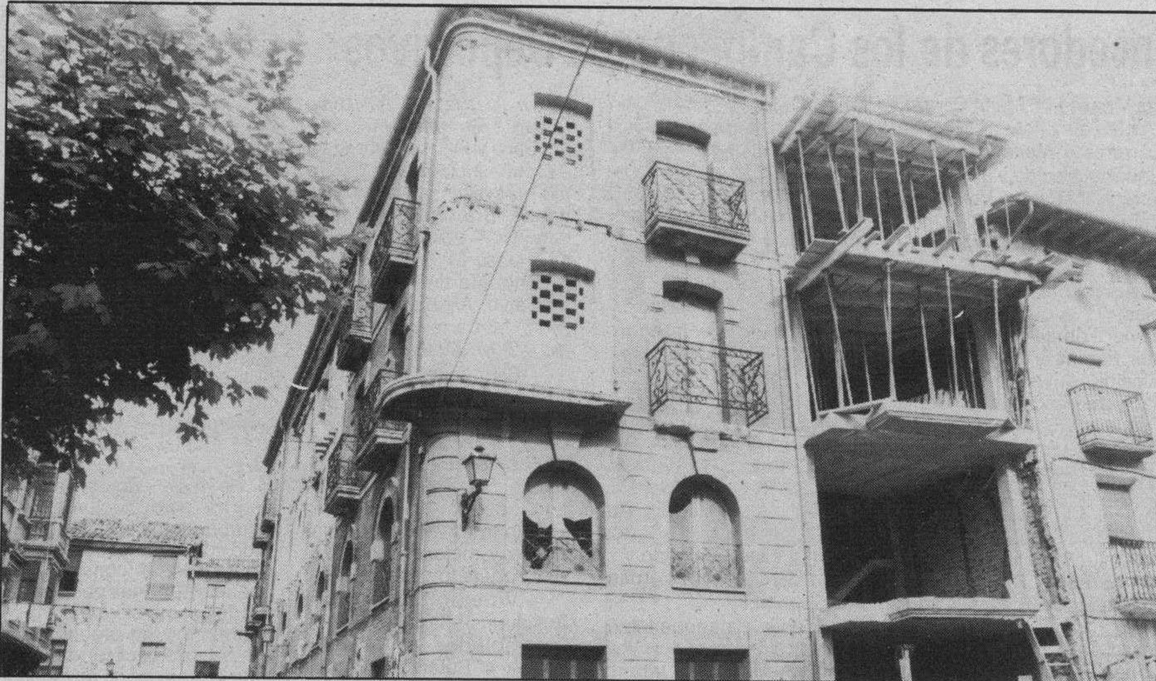
«El Casco Viejo volvió a estar presente en una comisión de servicios. Esta es la casa que se encuentra frente al Apolo, y cuyo propietario, la Caja del Círculo pretende rehabilitar, de momento su estructura. Con posterioridad podría ser empleada como residencia de ancianos».
