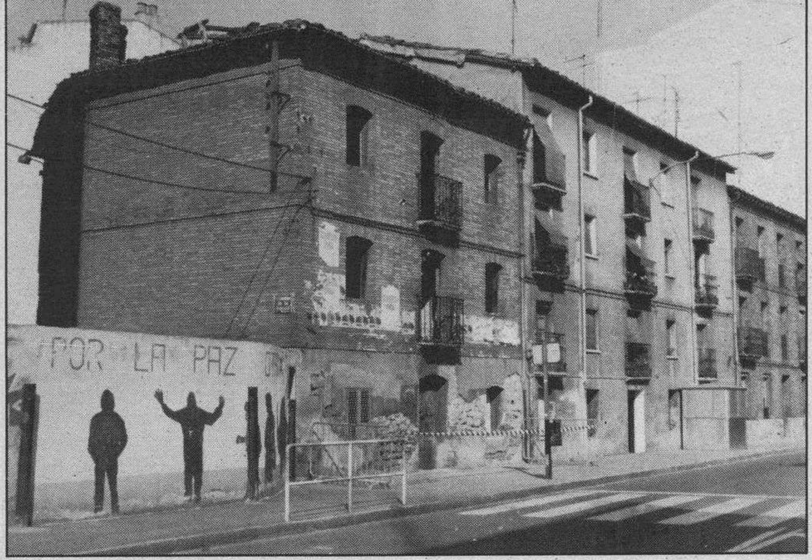
Derribos en la calle Logroño.
