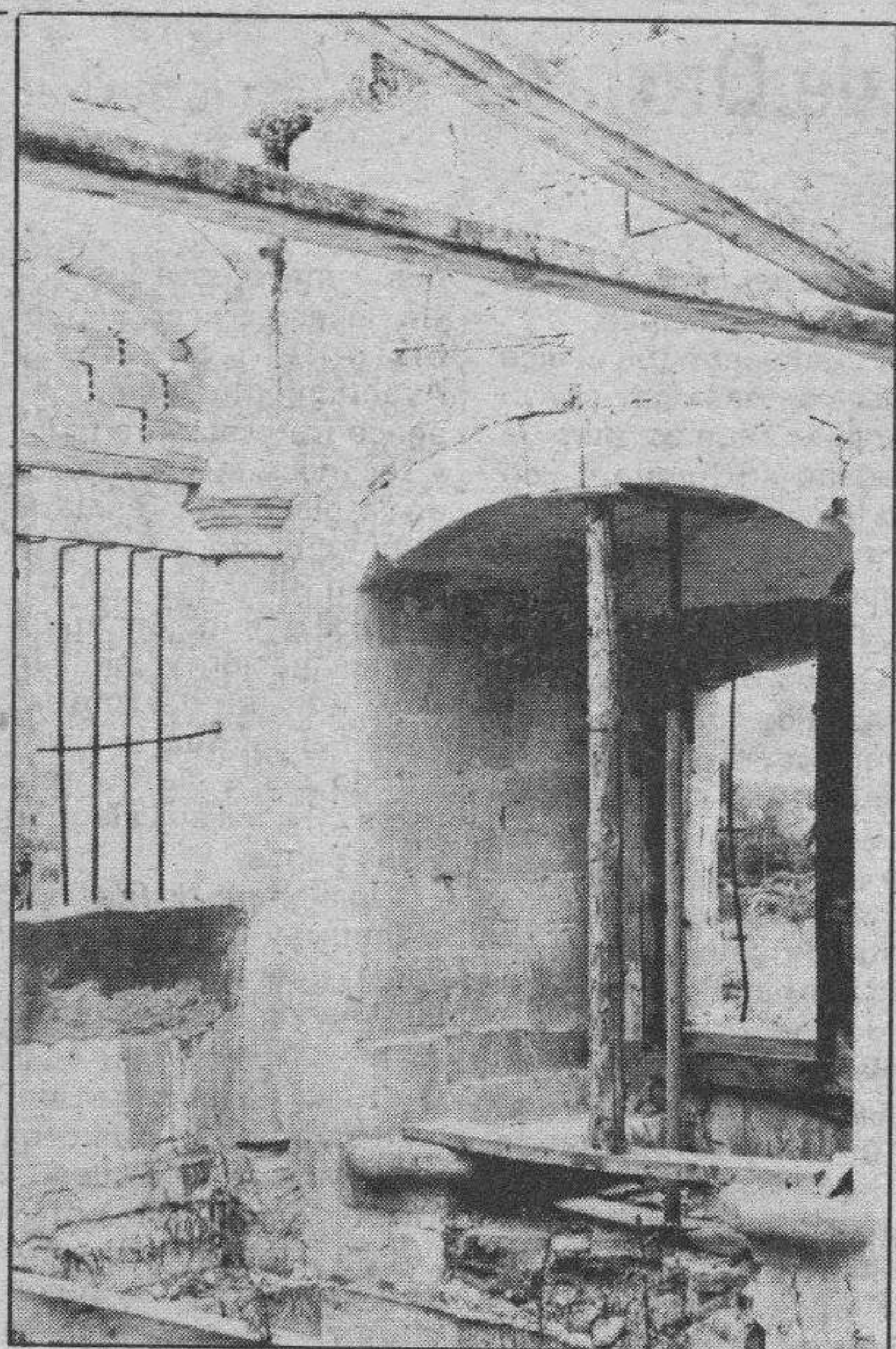
Arco de ventanal apuntalado en el Monasterio de Santa Clara, de Medina de Pomar.
