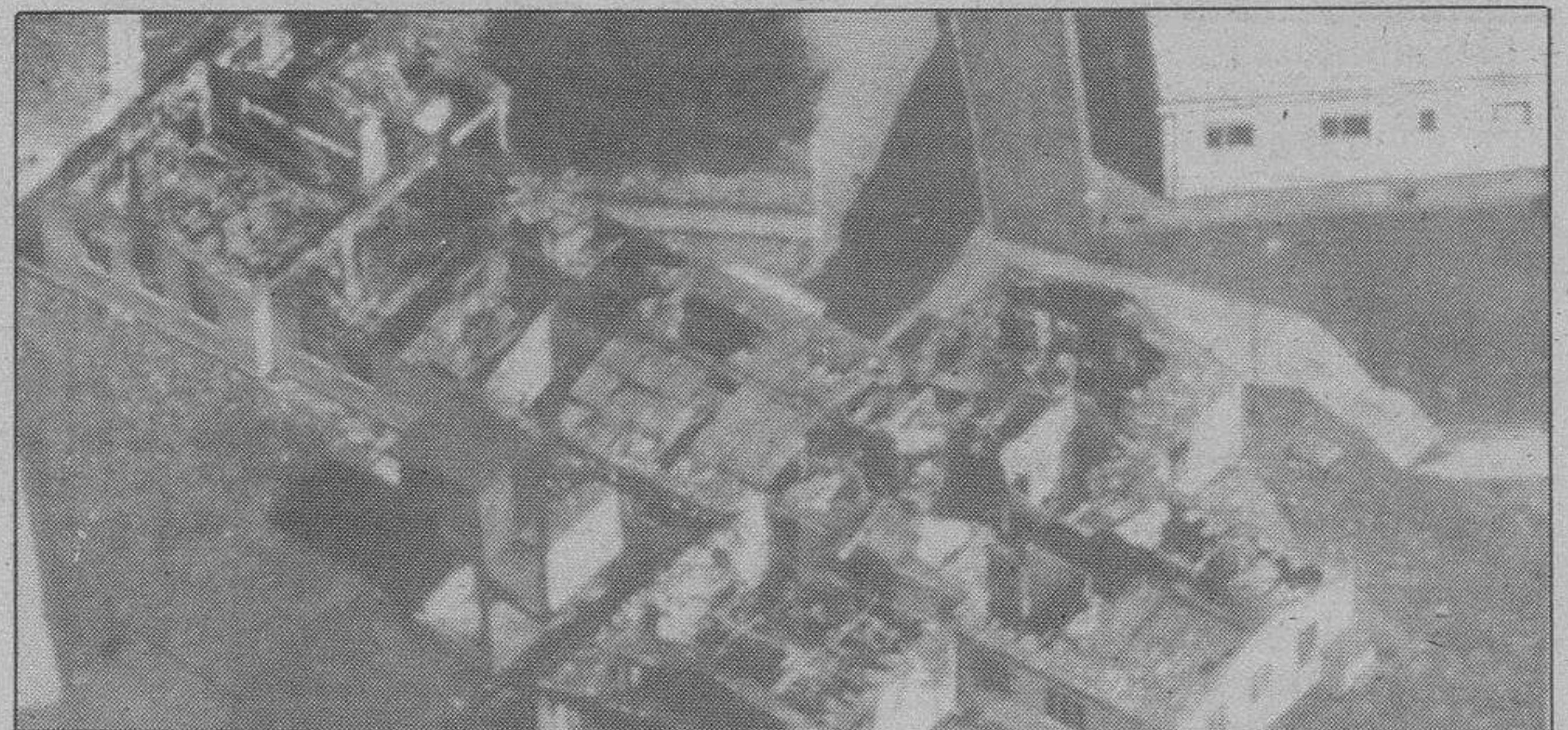
Prisión sin techo. — Vista aérea de la prisión Norteye, en Bexhill (Inglaterra), en la que pueden apreciarse los daños causados en el techo y el interior, a consecuencia del fuego que los reclusos iniciaron en el edificio dedicado a administración y hospital, los hechos ocurrieron durante un motín que duró toda la noche.
