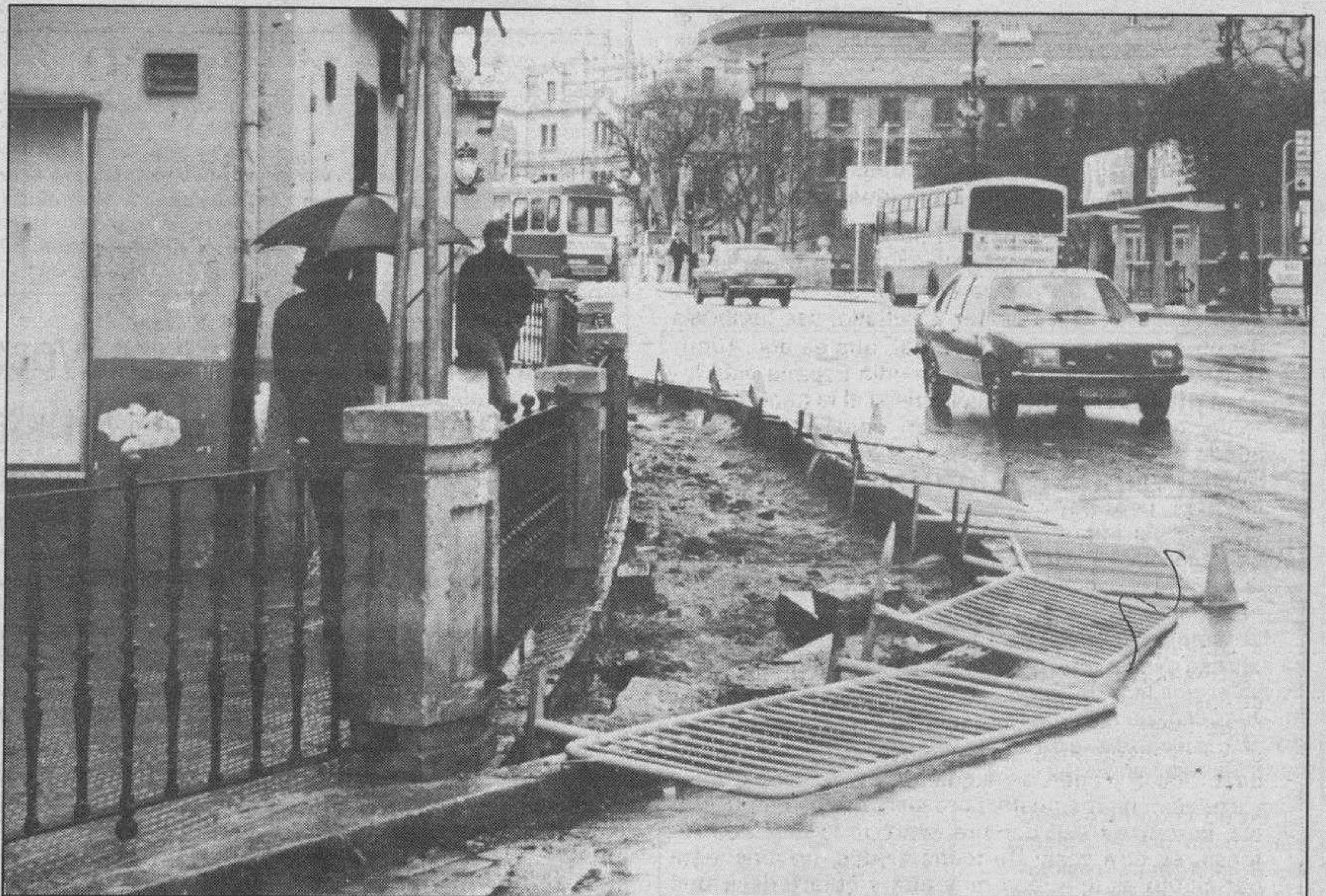
Acertada ampliación de esta acera. — Las obras de ampliación de la acera de la Plaza de Primo de Rivera a la de Santo Domingo de Guzmán permiten ya conocer cuál es la anchura que se dará a este paso peatonal. Es un acierto. Hasta ahora, difícilmente dos personas podían pasar por este lugar y por ello se ha aprovechado la ocasión para modificar el trazado.
