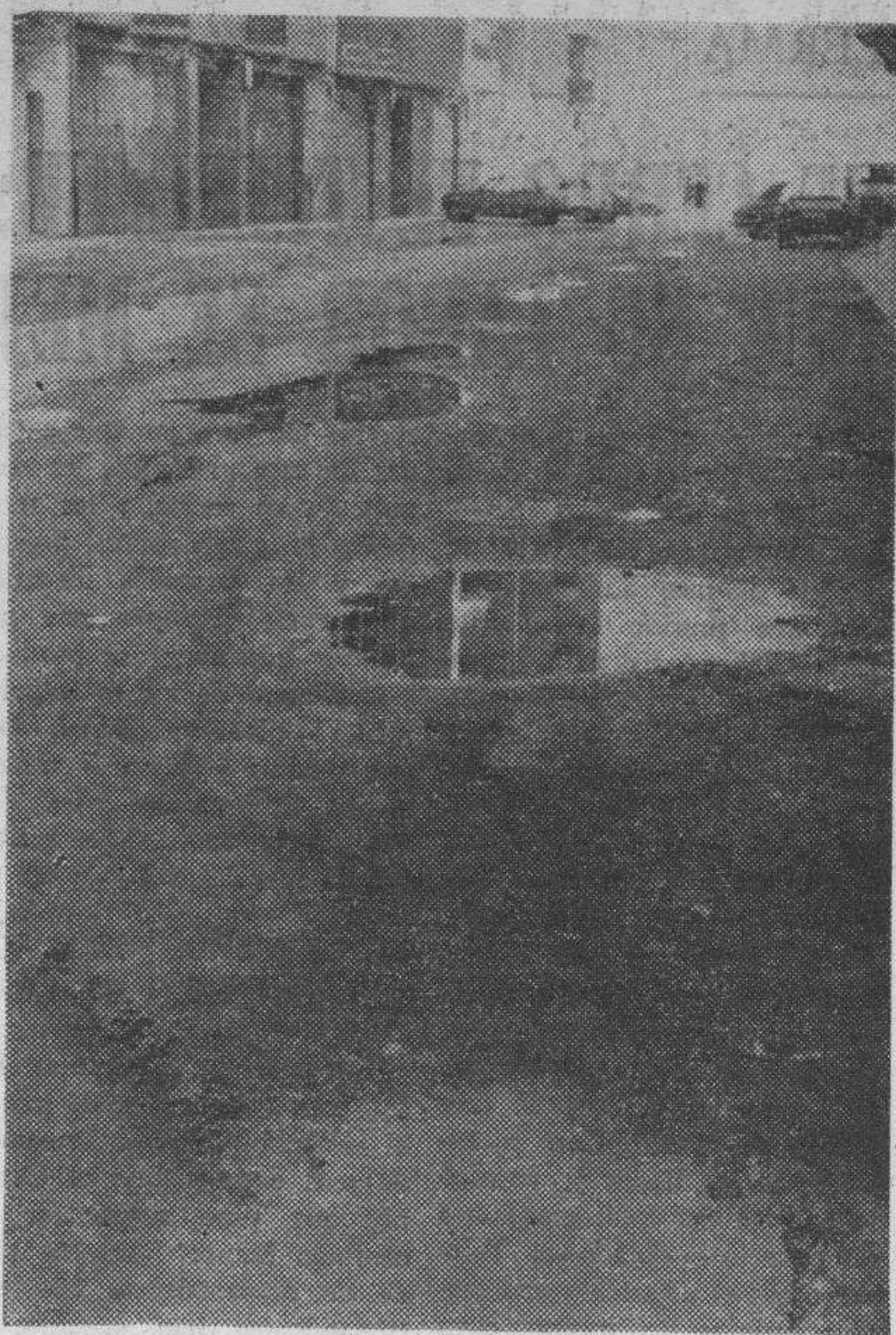
La Carretera de la Estación, una antigua demanda, un lamentable estado, una futura solución. (Foto Florentino Lara)
