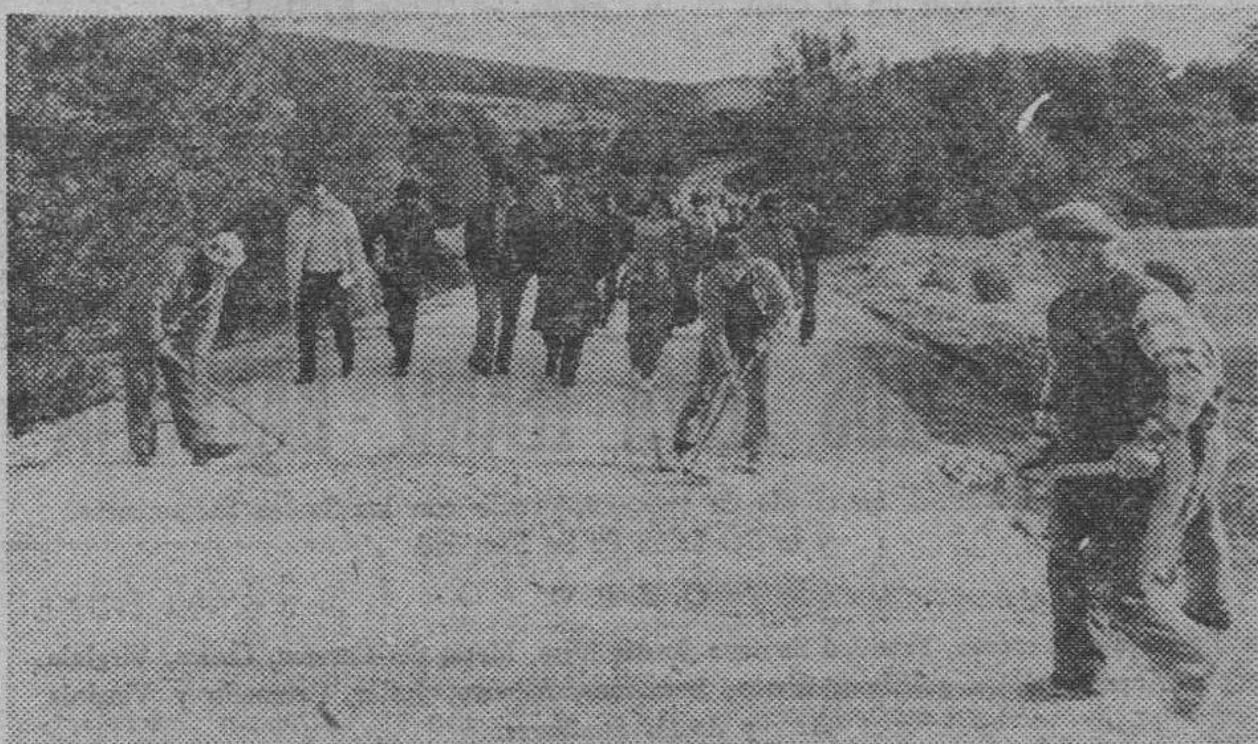
Mediante prestación personal y con la colaboración de la maquinaria y técnicos de uno de los Equipos de Ayuda Municipal de la Diputación, en Arauzo de Miel se están ultimando los trabajos de transformación a firme bituminoso de dos caminos de una longitud total de cuatro kilómetros. El grabado recoge un momento de la visita efectuada por el señor Montoya Ramos. — (Foto FEDE)
