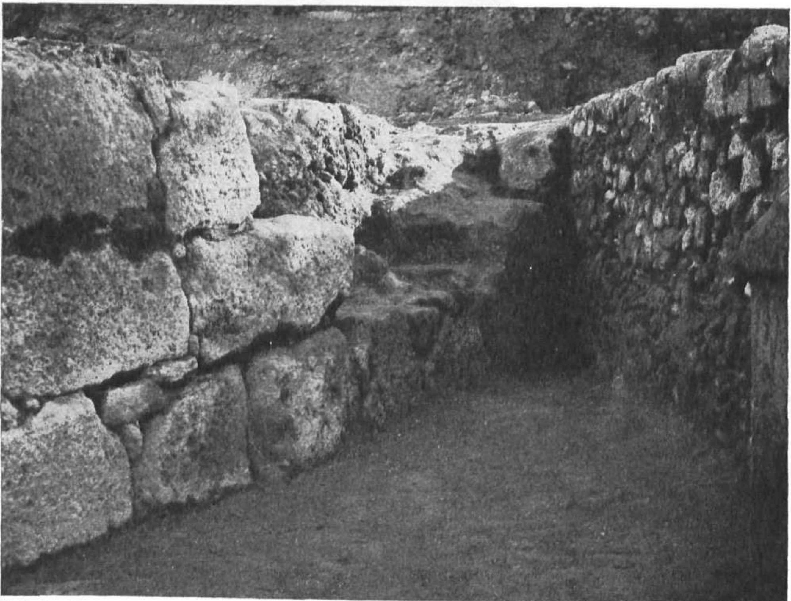
Fig. 5.—Intersección muro-murete. A la izquierda, sobre el muro, hormigón moderno que provoca rotura muro.
