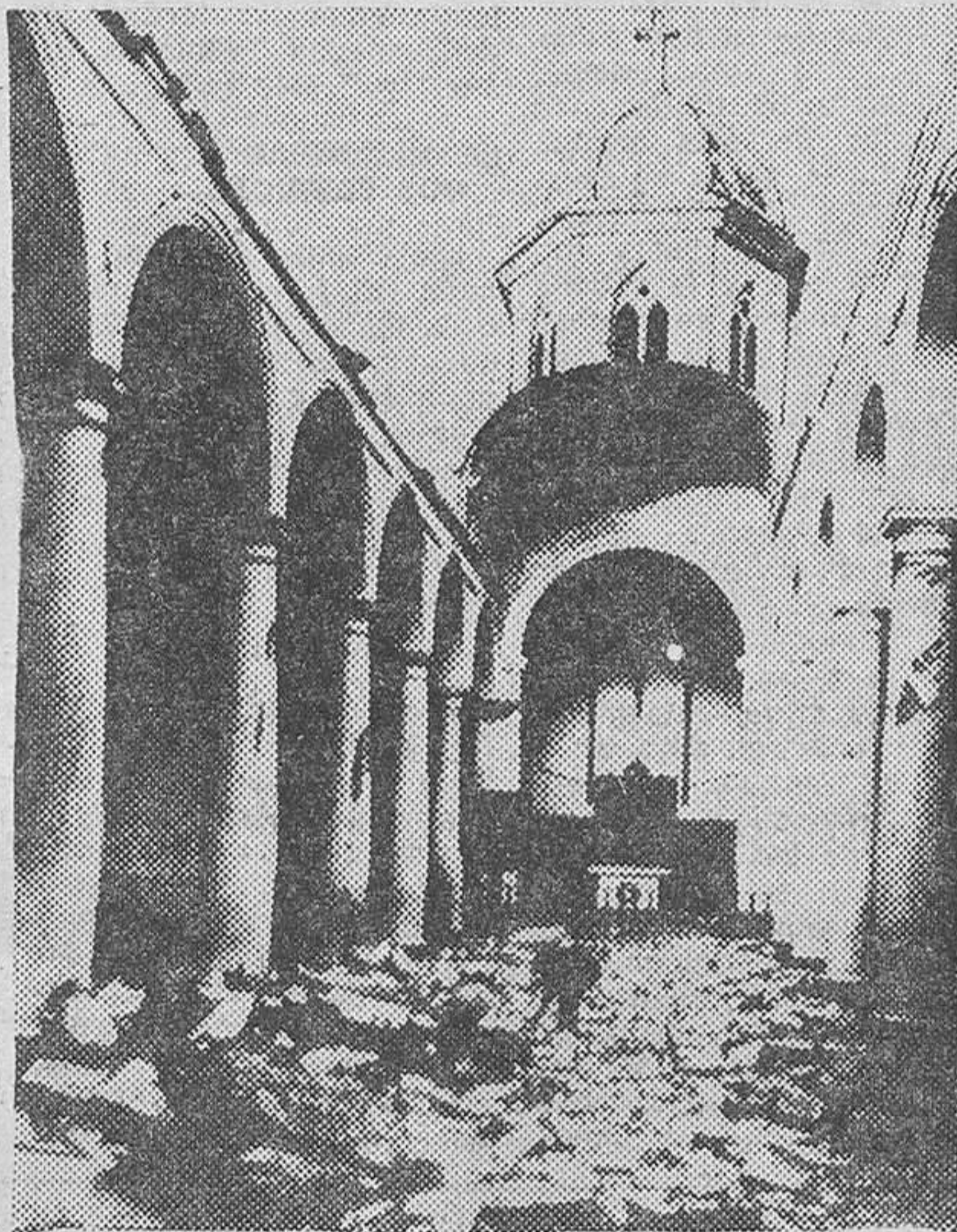
San Cristóbal (Venezuela). — El techo de esta iglesia se vino abajo como consecuencia de un fuerte terremoto ocurrido en la frontera venezolano-colombiana. En los trabajos de rescate fueron hallados ocho cadáveres. — (Telefoto Efe-Upi)
