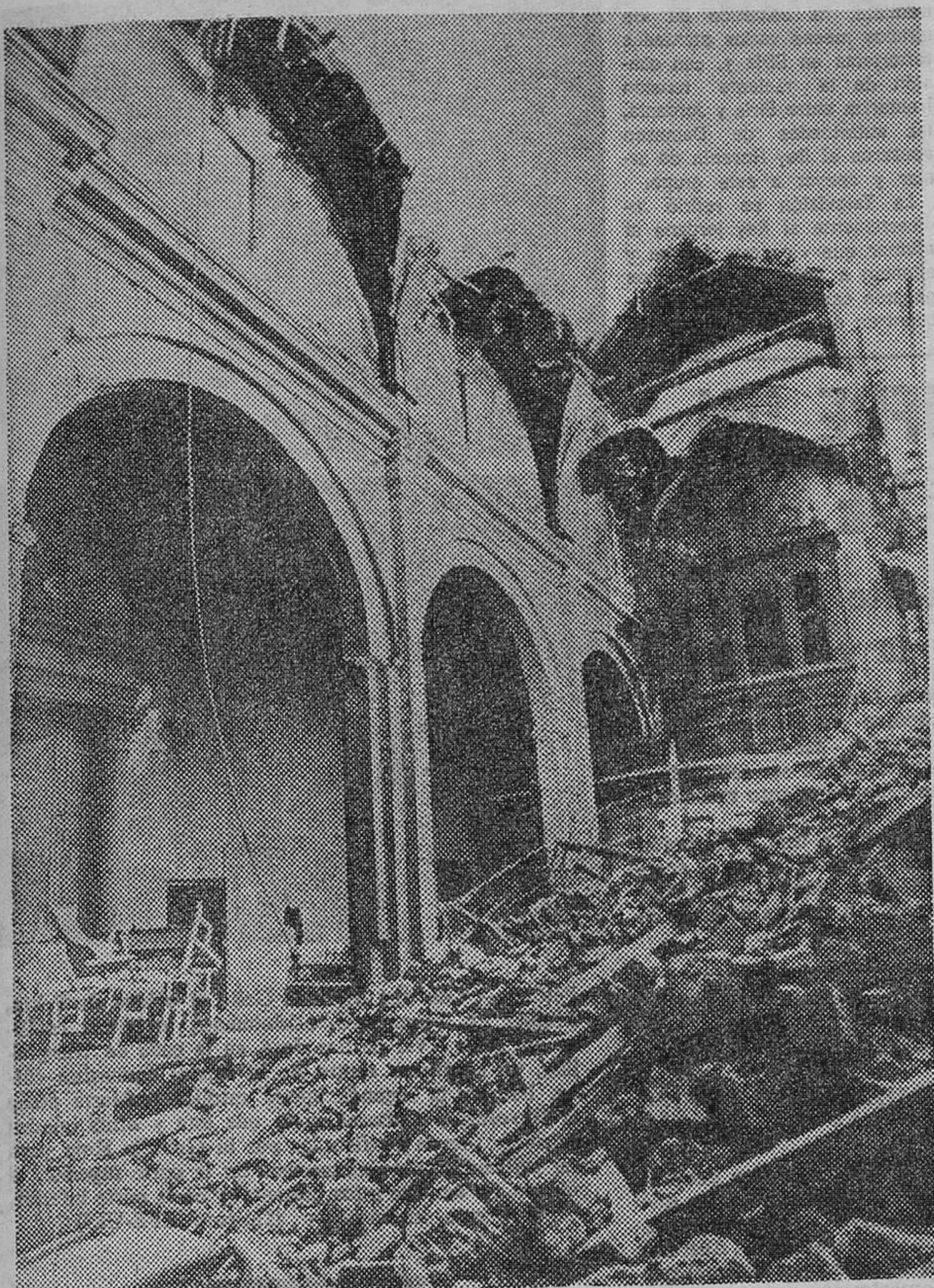
Córdoba. — Ocurrió la pasada Nochebuena, a mediodía se derrumbó la techumbre de la iglesia de Santiago Apóstol, de Córdoba, en ella se encontraban trabajando 12 albañiles que este día no asistieron al trabajo por ser Nochebuena. Ello pudo salvar sus vidas. Esta iglesia sufrió un aparatoso incendio el 20 de Diciembre del pasado año. Los daños tras el derrumbamiento de este año son cuantiosos. — (Telefoto Europa Press)
