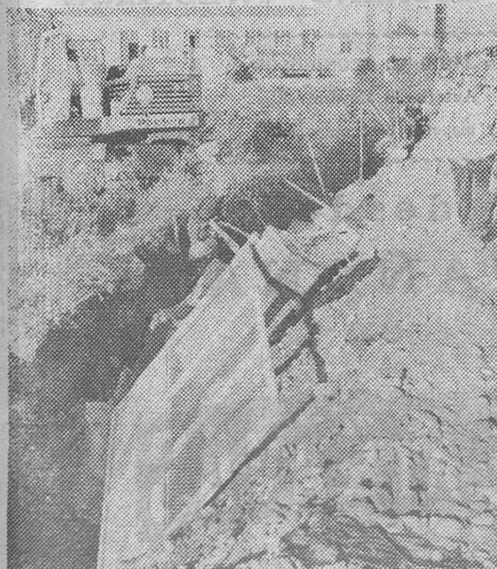
Ayer tarde se registró un triste suceso en «El Capiscol», donde a causa de un desprendimiento de tierras resultaron
