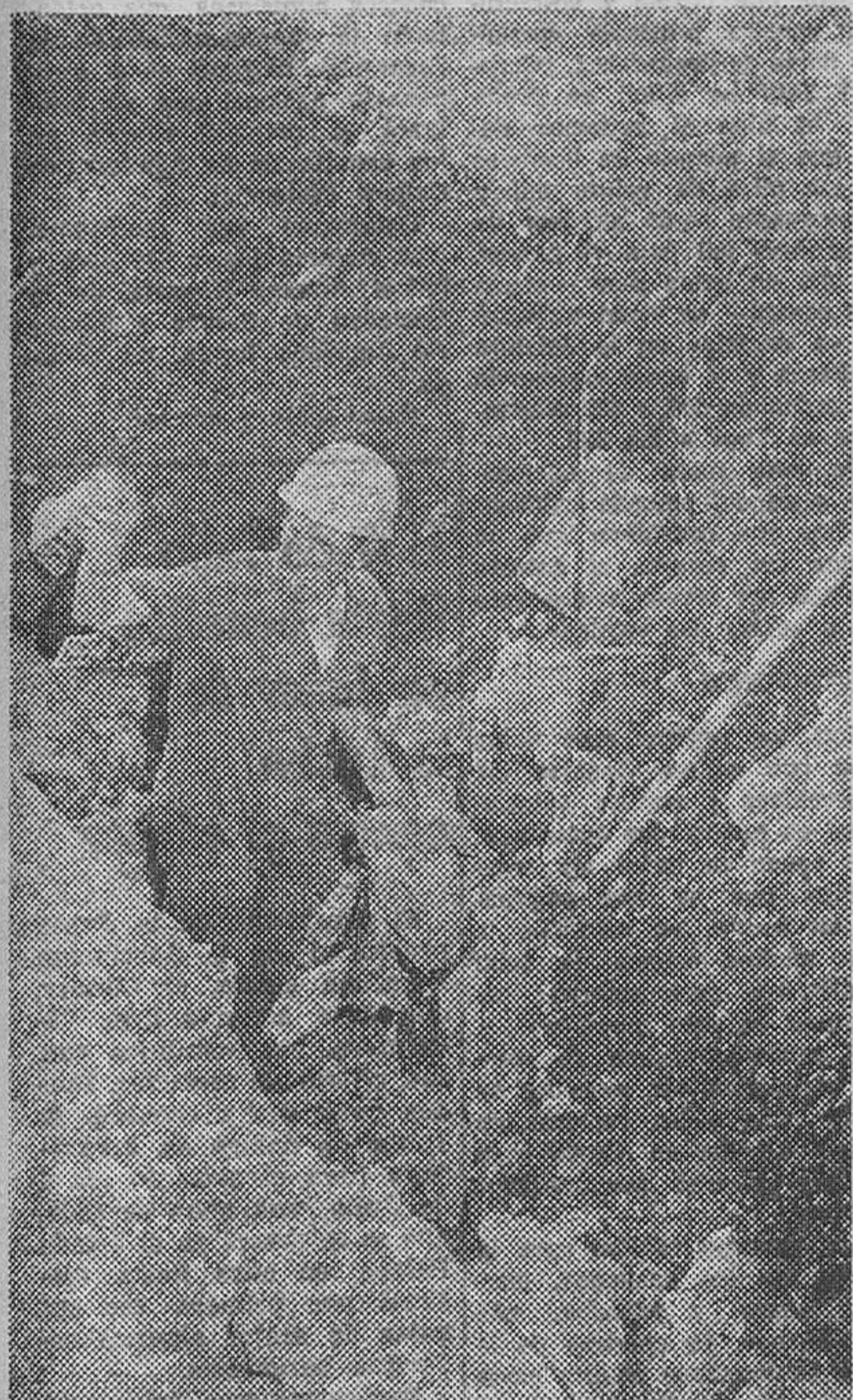
Un momento de los trabajos de descombra de la zanja en la que quedaron enterrados, encontrando la muerte, dos obreros de la empresa «Hidroconstrucciones». — (Foto FEDE).
