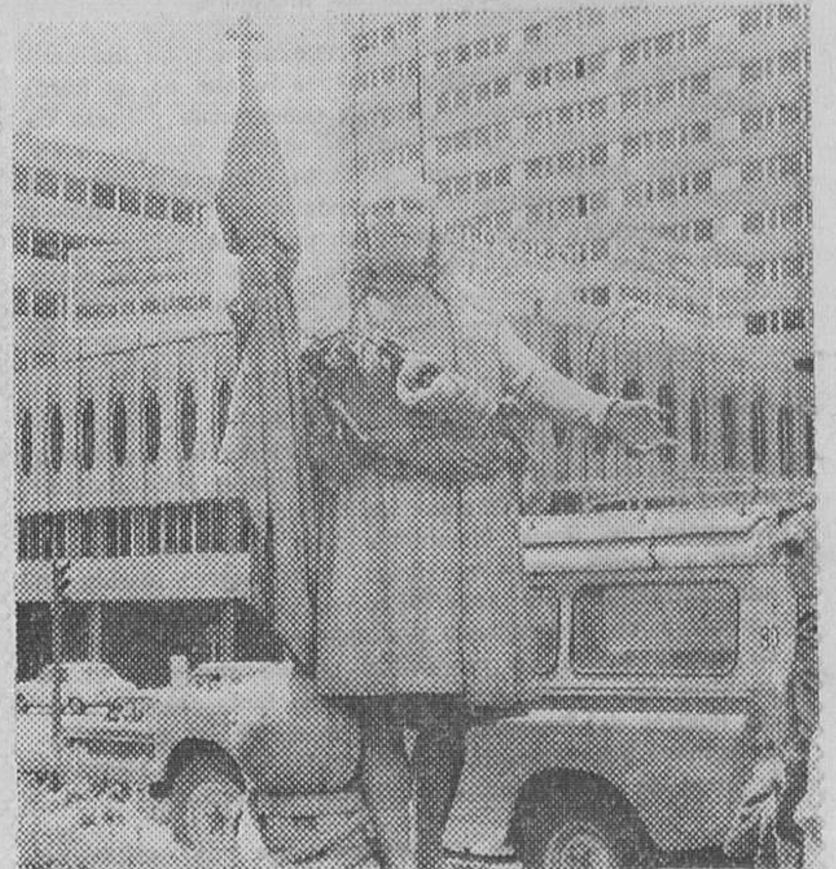
Madrid. — Un aspecto de los trabajos de traslado de la estatua de Cristóbal Colón, en la plaza de su nombre, a su nuevo emplazamiento, en el antiguo solar de la Casa de la Moneda, entre dicha plaza y las calles de Goya y Jorge Juan, con motivo de la ordenación urbana que se llevará a cabo en la citada plaza. — (Foto CIFRA GRAFICA).
