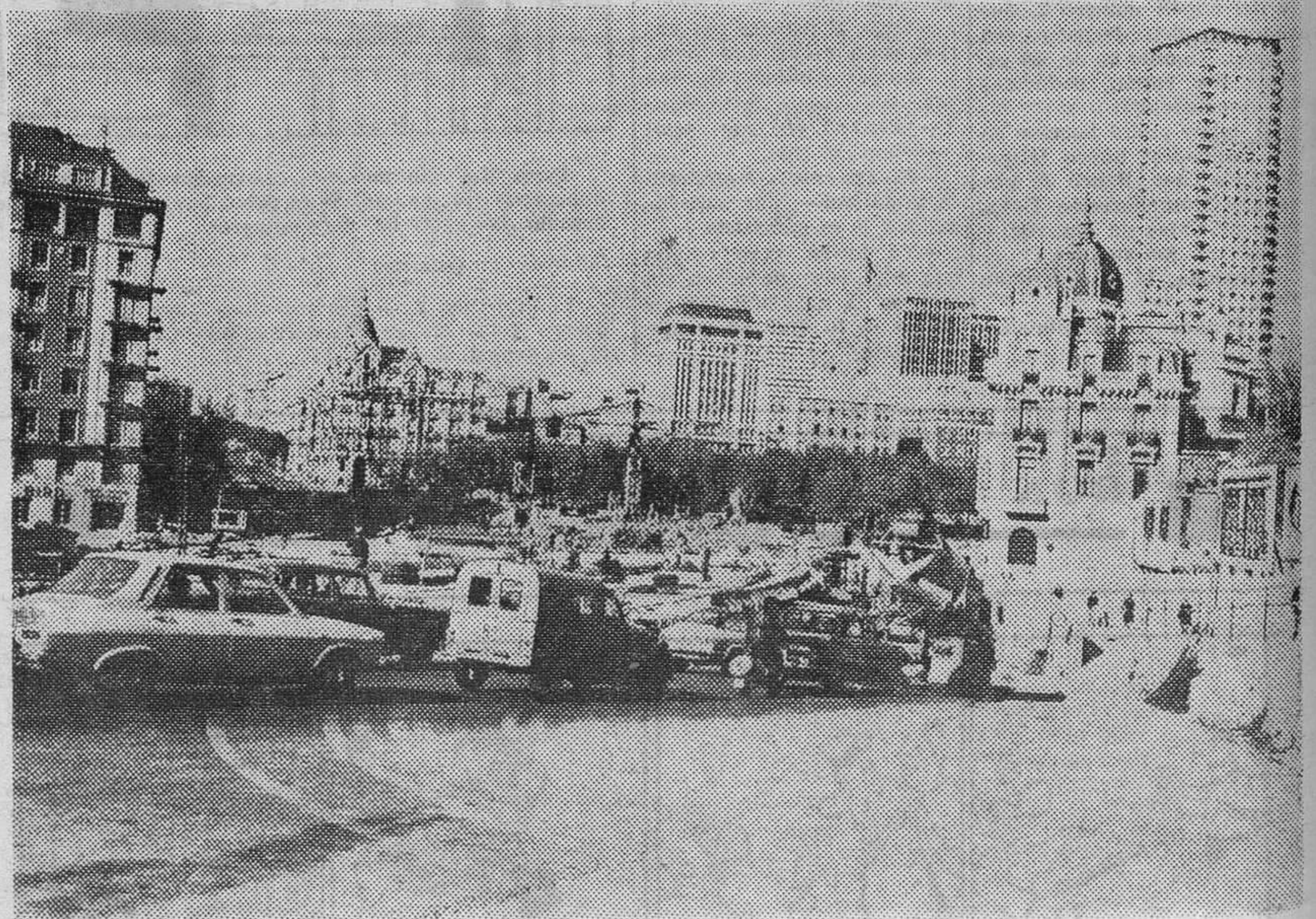
En la confluencia de la calle de Bailén con la Plaza de España, en Madrid, se está construyendo un paso a distinto nivel o viaducto. Será el segundo de la calle de Bailén porque, como se sabe, el más antiguo y famoso viaducto de la capital de España está en esta calle. La fotografía muestra el estado actual de las obras de construcción de este nuevo paso a nivel que resolverá los problemas de tráfico en un punto tan conflictivo como es Bailén-Plaza de España-Ferraz-Paseo de Onésimo Redondo. — (Foto Fiel)
