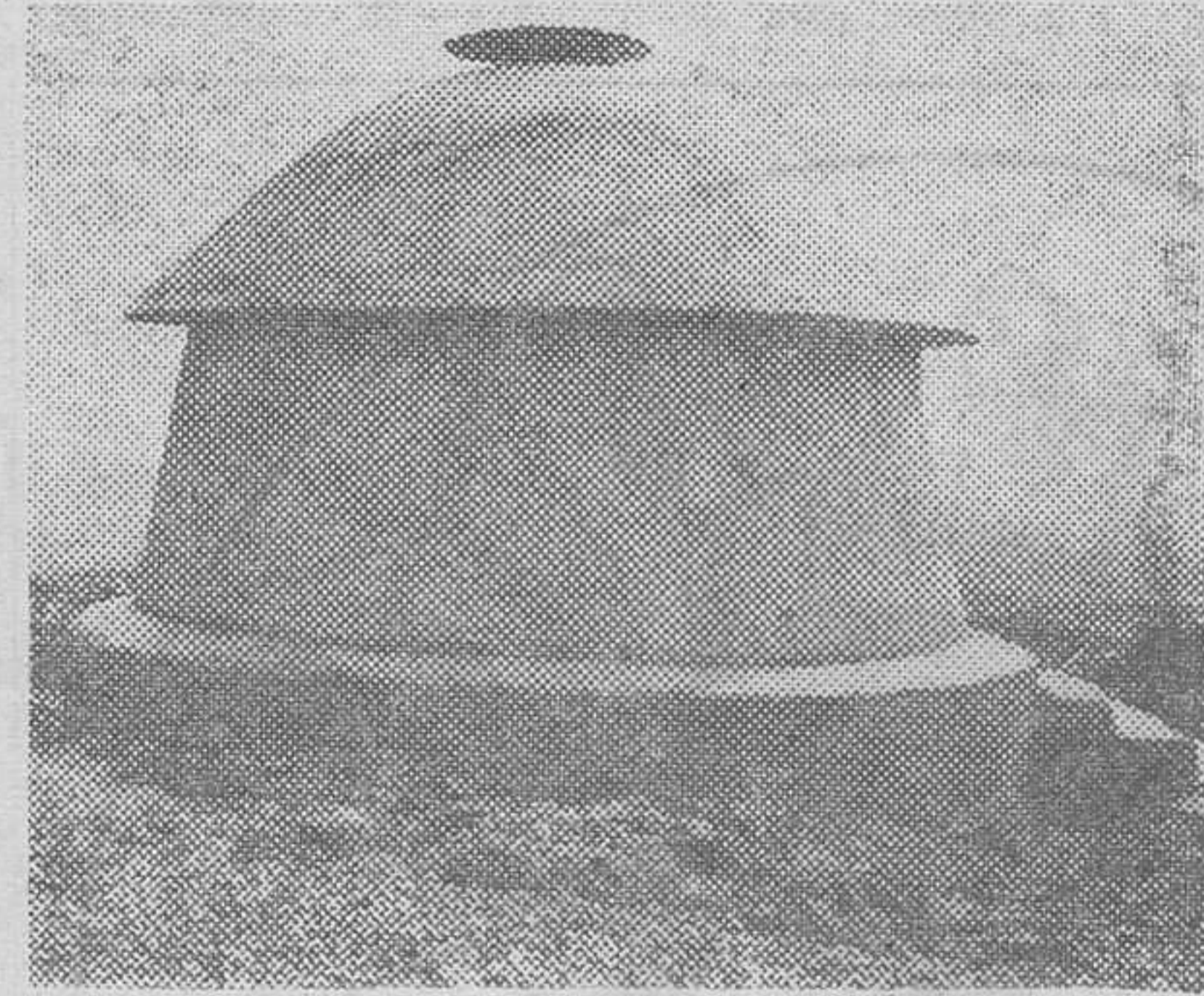
Caseta que ha de servir de base para la instalación del poste repetidor de T.V.E. que ha de mejorar la recepción de los programas en la cuenca del Duero. (Foto DIAZ)
