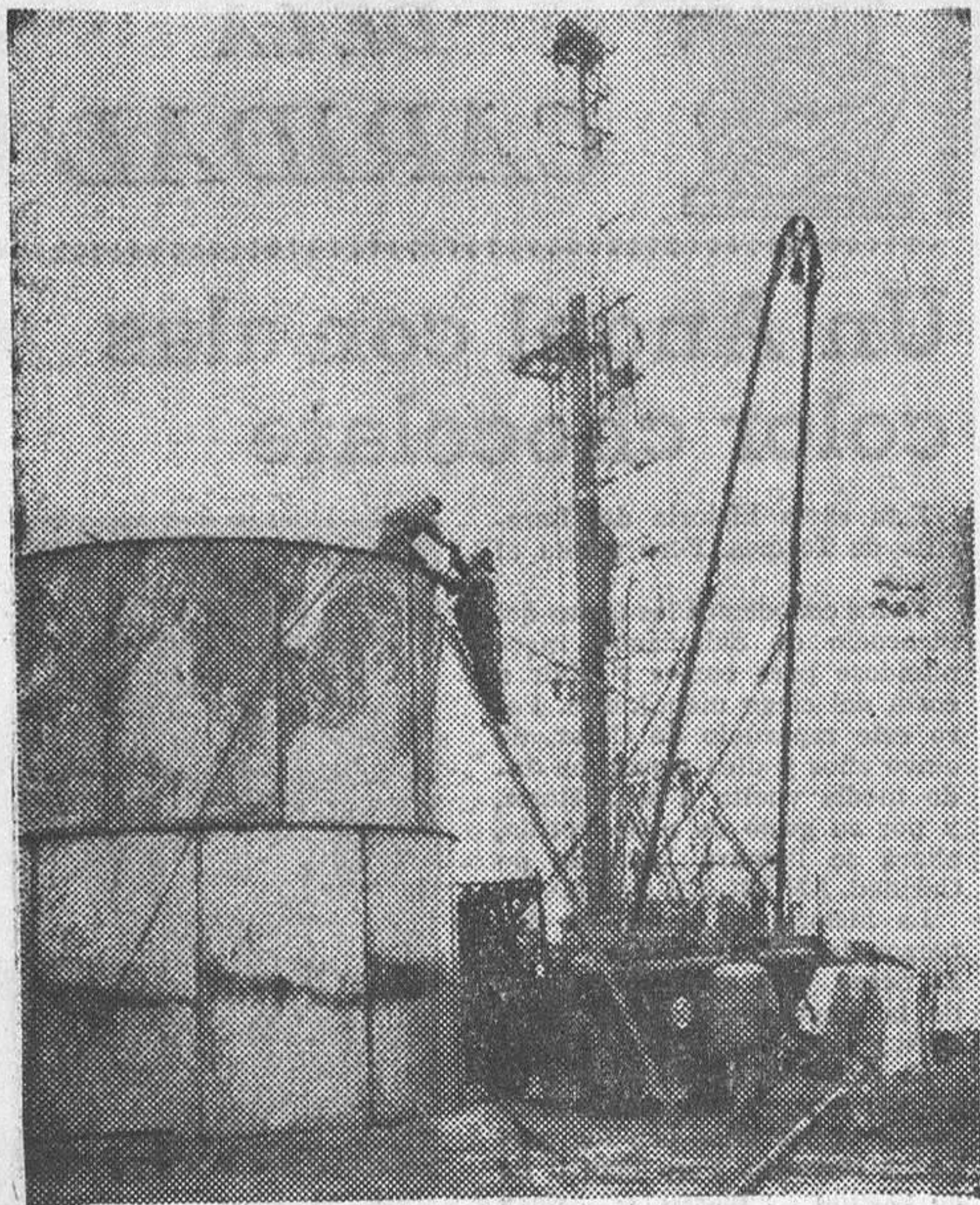
Momento en que operarios de las prospecciones trabajan en la instalación final del primer tanque-cisterna del segundo pozo.—(Foto FEDE)
