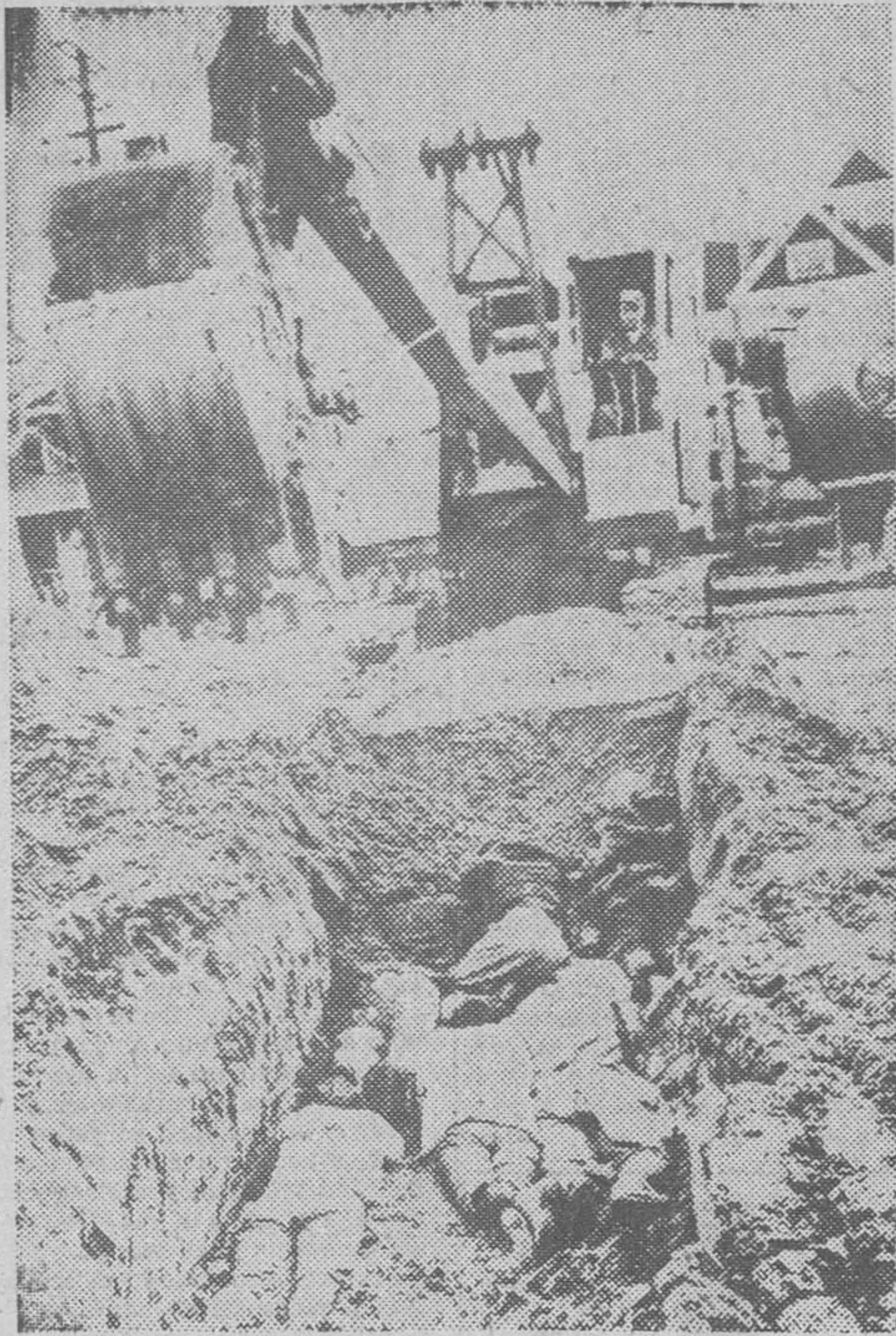
Cleveland, Ohio (Norteamérica). — Manifestantes partidarios de los Derechos Civiles se echaron en el fondo de una zanja, abierta en un solar, para edificar una escuela. Y no se desanimaron en su propósito, a pesar de que una máquina excavadora les echó encima una buena paletada de tierra. — (Foto Cifra)
