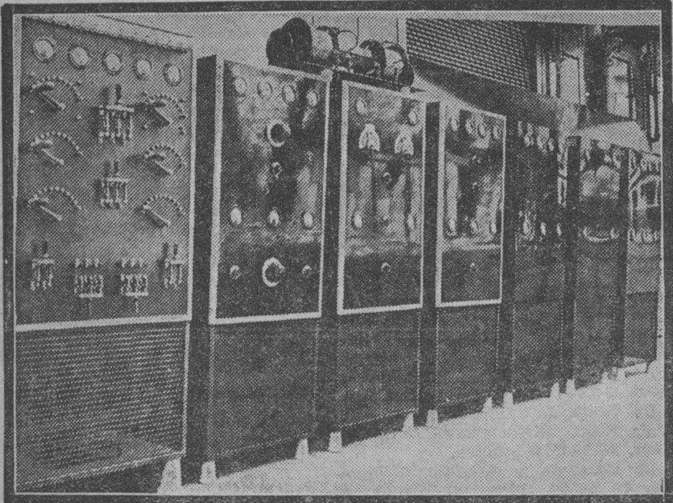
Una serie de elementos correspondientes a varias instalaciones. (Fotos. A. de la Barrera)
