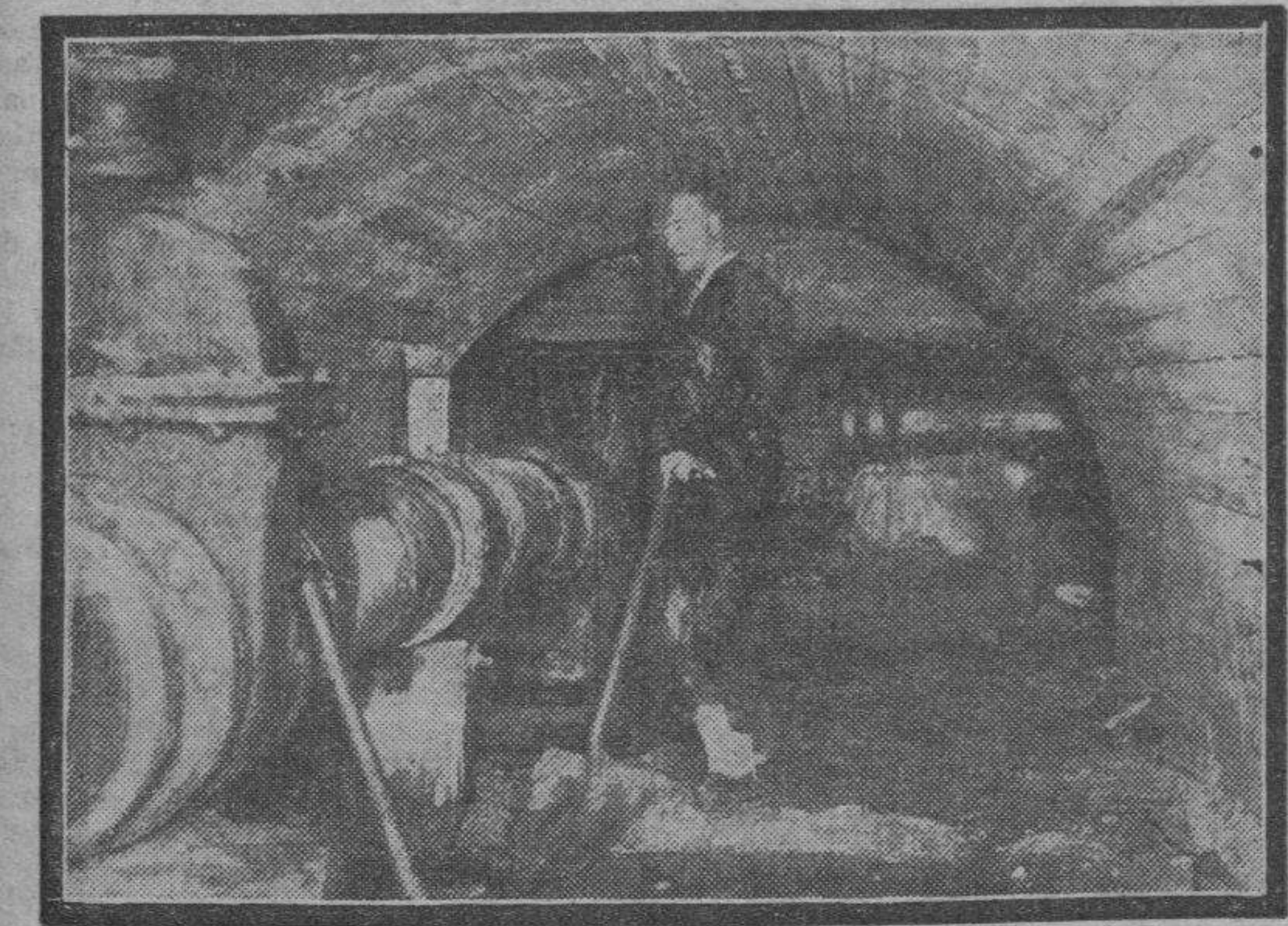
En el centro de la enorme T, donde se unen las dos tuberías y se encuentran los caminos subterráneos que conducen al paseo de la Independencia y al Coso. Se aprecia en la fotografía la humedad y el fango del recinto.
