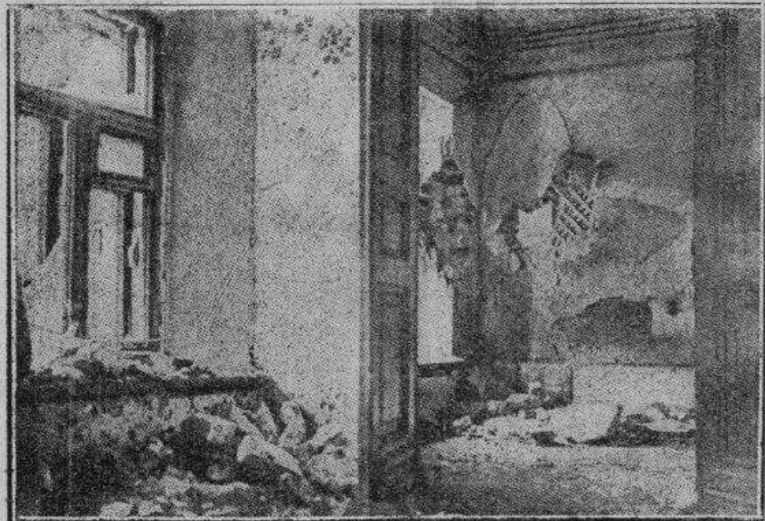
En el barrio Tchugaet. Casa destruida por las bombas.
