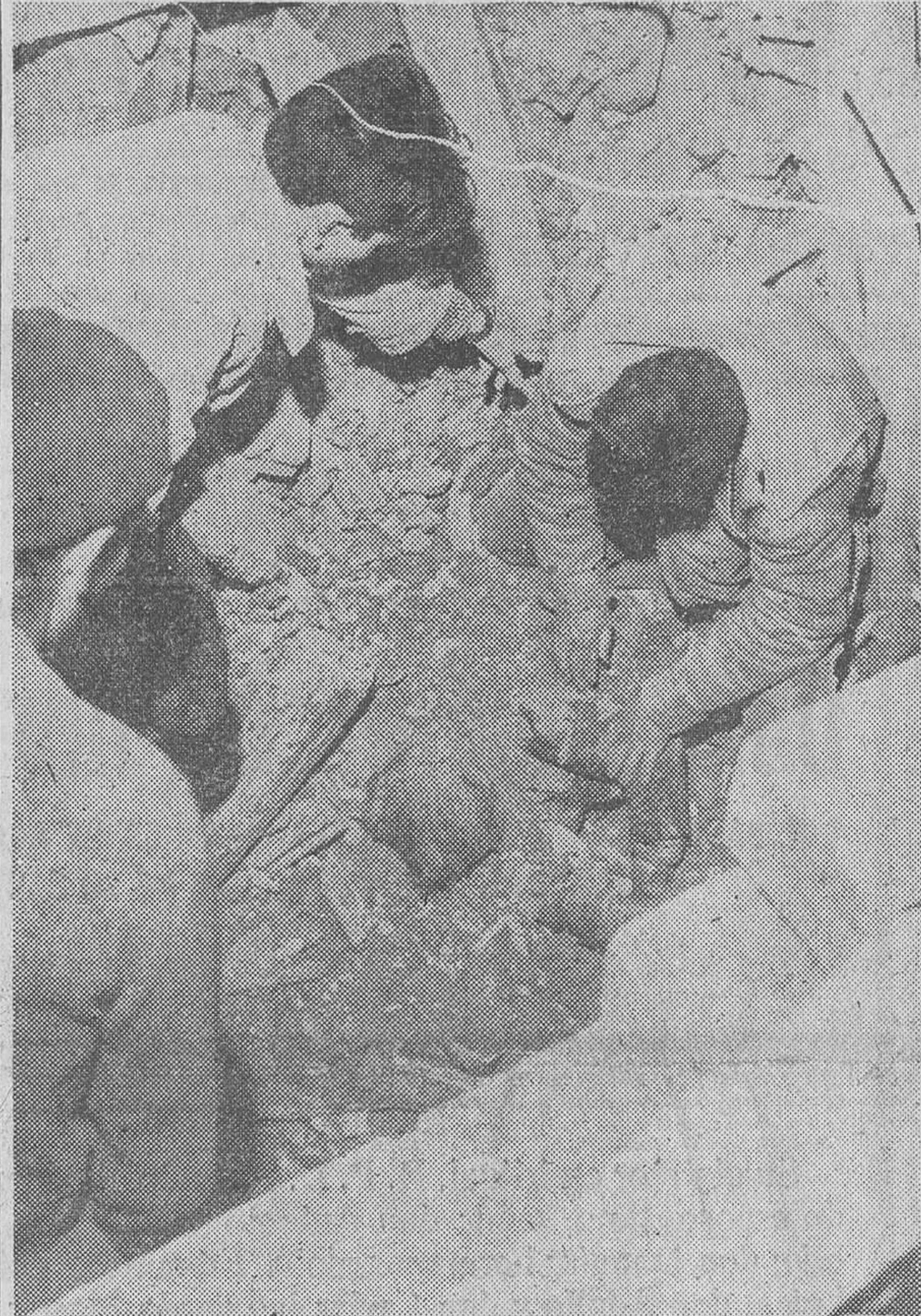
Un obrero que trabajaba en las obras de construcción de un edificio resultó muerto al derrumbarse parte de un ala de la casa, a consecuencia de ceder los cimientos por reblandecimiento del terreno, con motivo de los recientes temporales de lluvia. Se tardaron varias horas en rescatar el cuerpo del infeliz, que quedó sepultado entre los escombros. He aquí el patético momento en que el cadáver es encontrado por los compañeros del infortunado obrero
