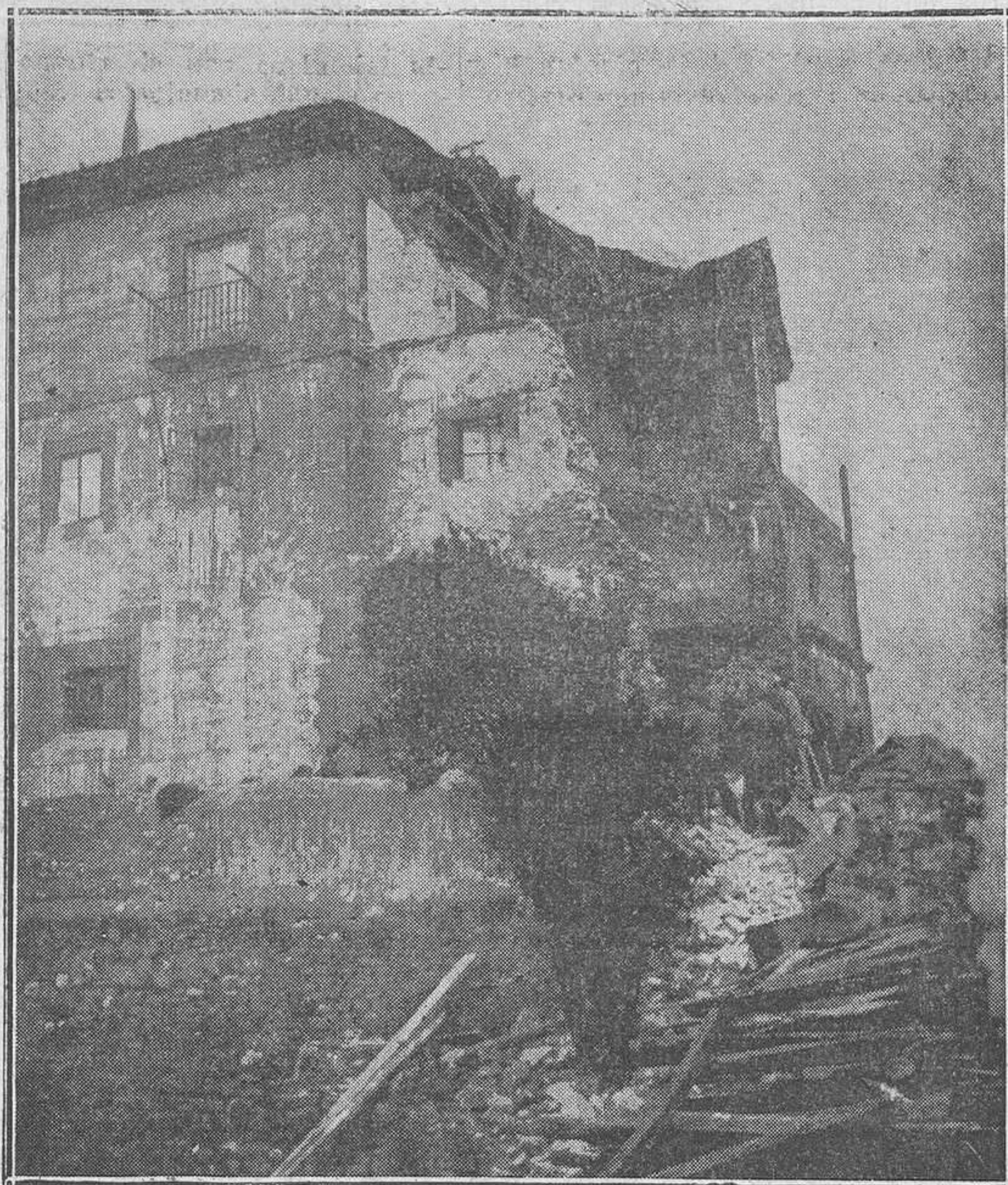
OVIEDO.--El hundimiento ocurrido ayer tarde en la Casa-cuartel de la guardia civil, en San Vicente. Estado en que quedó el pabellón hundido, y que habitaba el teniente coronel y su familia. (Foto Pardo)
