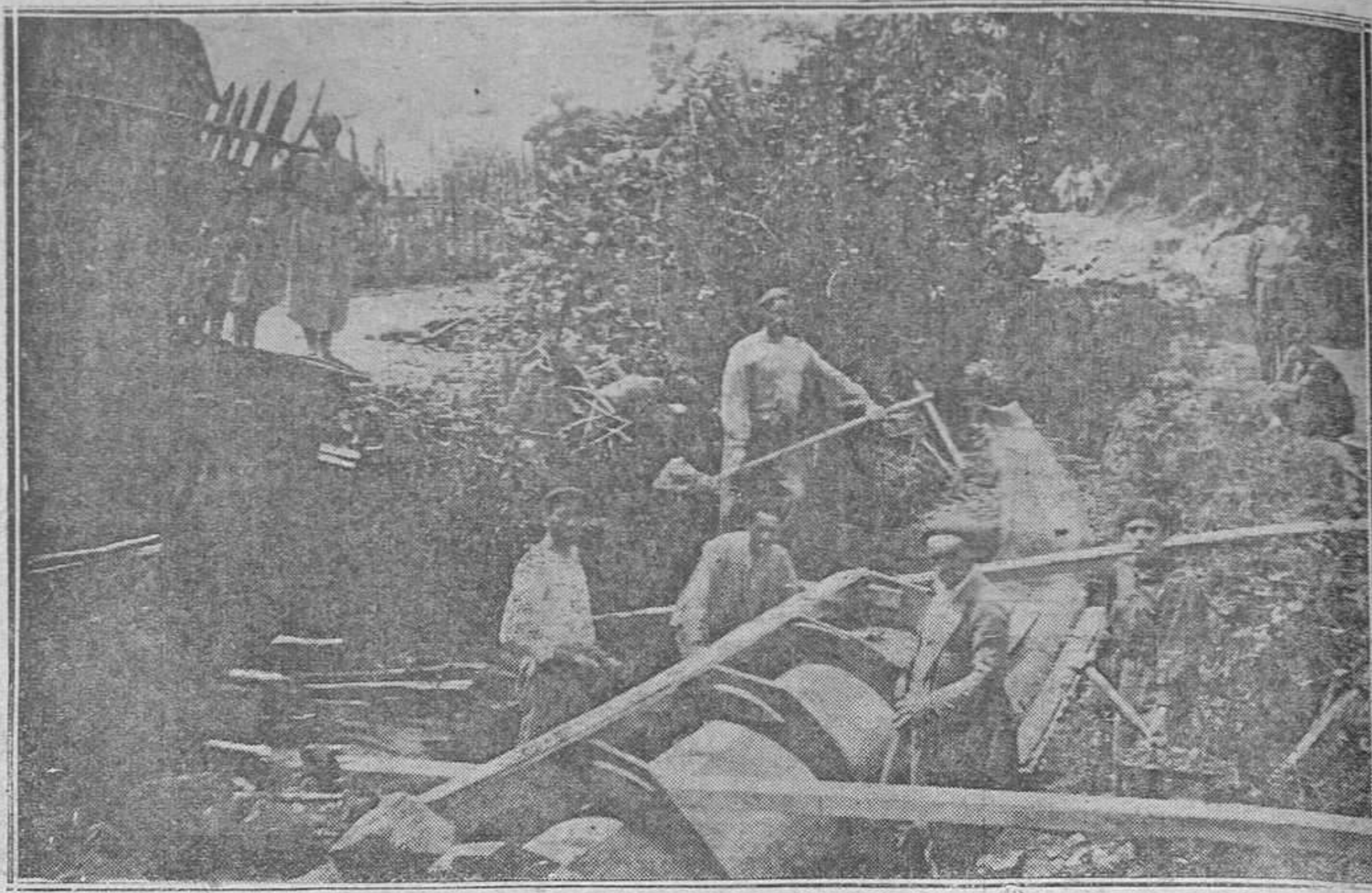
LADA (LANGREO).-Los primeros trabajos que se realizan en la carretera en construcción, que une a Lada con San Miguel, la iglesia y el cementerio; y cuya necesidad era grandísima en este pueblo. (Foto Couso)
