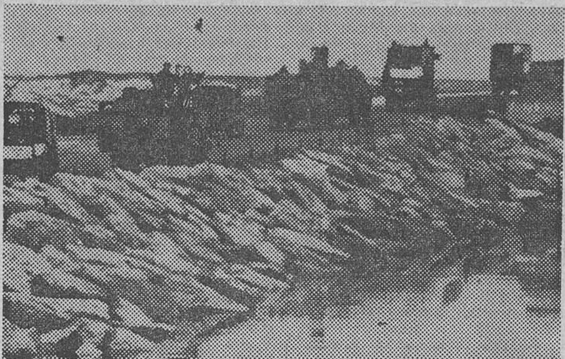
Tras la pausa impuesta por el sábado judío, varios vehículos militares israelíes reanudaron hoy la retirada hacia el interior del Sinaí, a través del mismo puente construido por las fuerzas judías cuando en un ataque relámpago cruzaron el Canal
