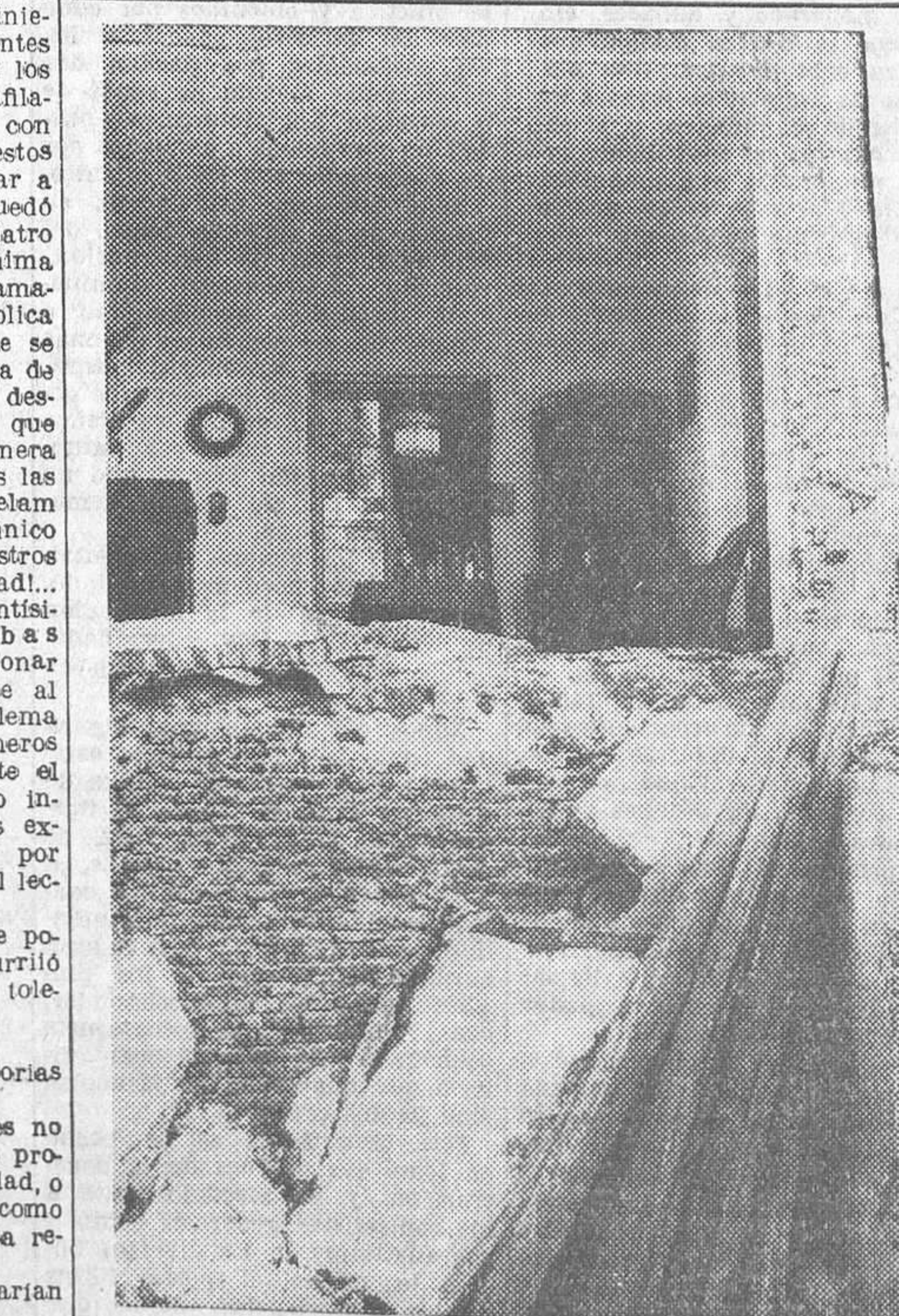
Estado en que quedó la casa de Antonio Grito, después del hundimiento ocurrido anteayer. (Fot. Alfonso.)
