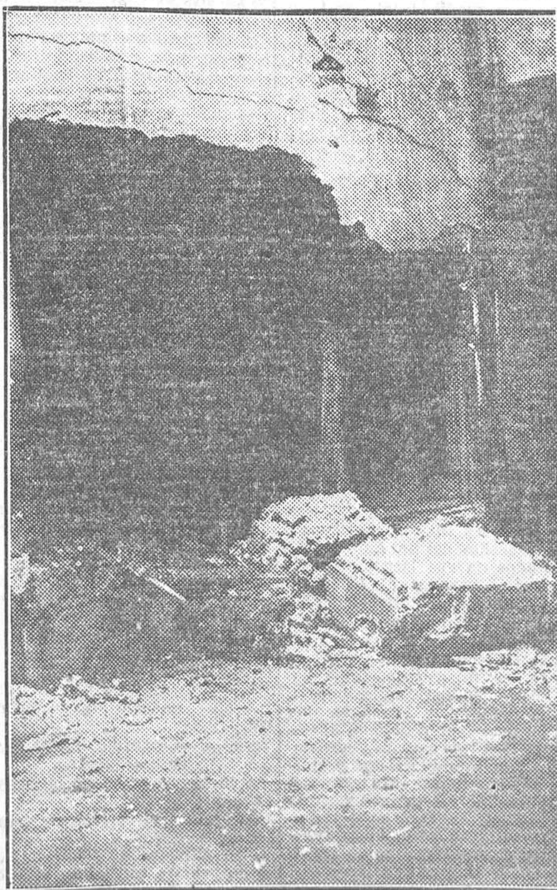
Hundimiento en la casa número 4 de la calle del General Pardiñas, que ayer produjo gran alarma entre los inquilinos de la contigua, correspondiente al 135 de la calle de Alcalá
