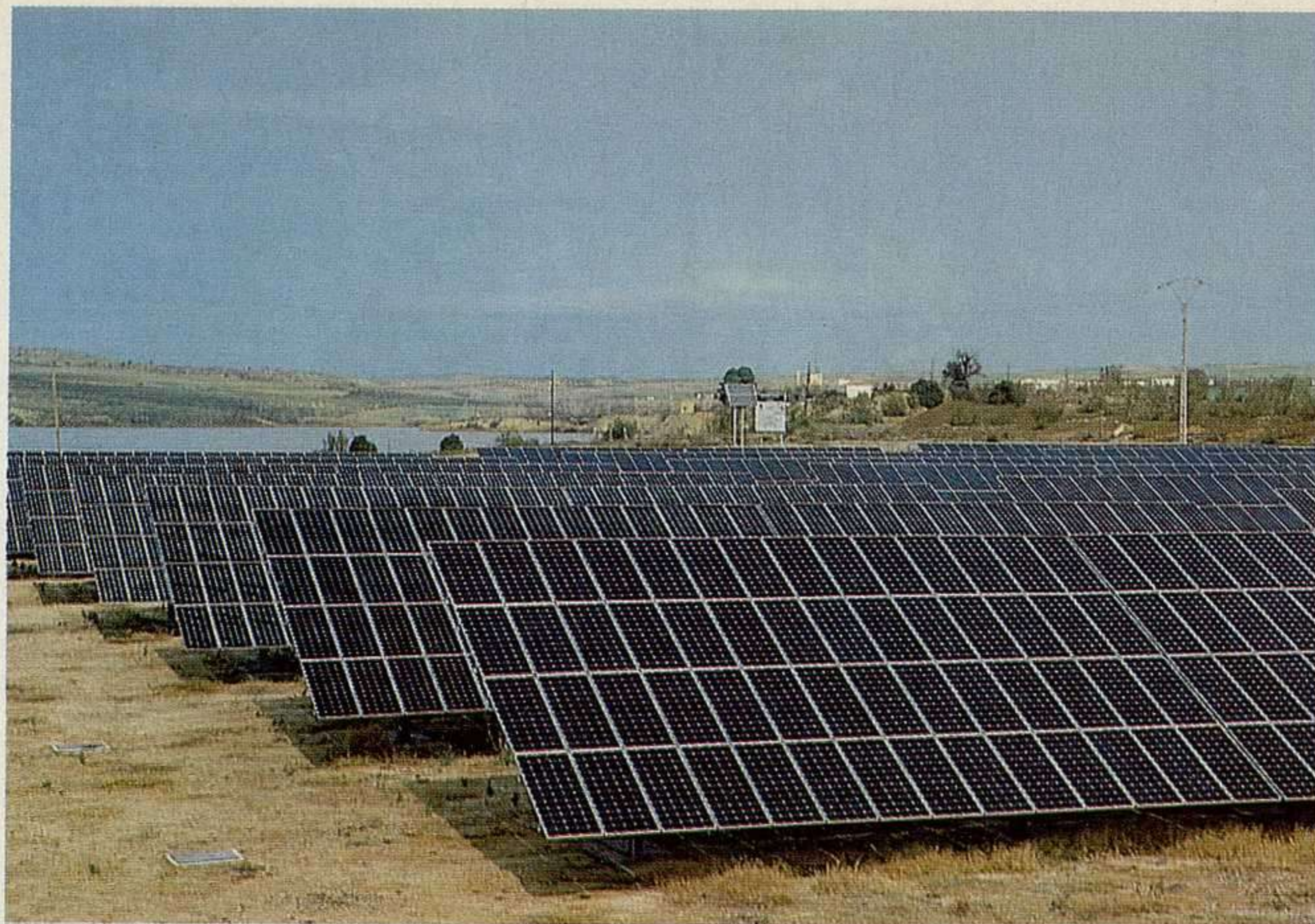
Central fotovoltaica de Toledo, con una potencia de 1.000 kWp, ocupa 8.000 metros cuadrados y produce cada año 1.600 MWh.
