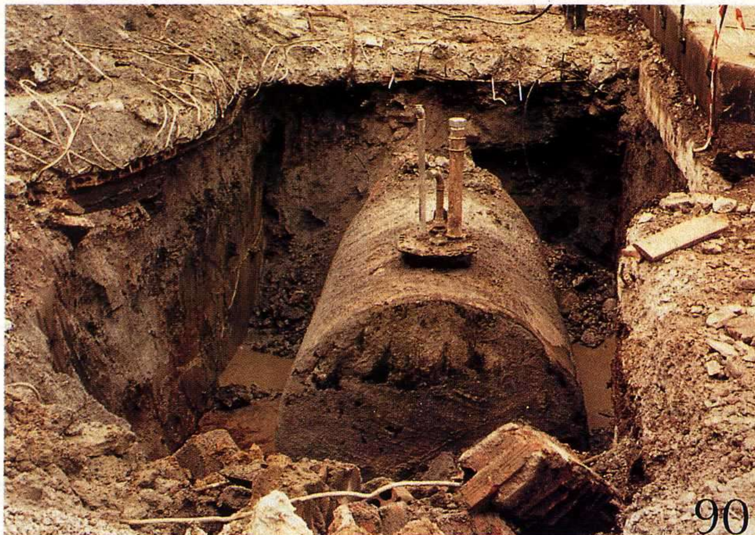
Tanque subterráneo de una gasolinera donde se produjeron fugas.
