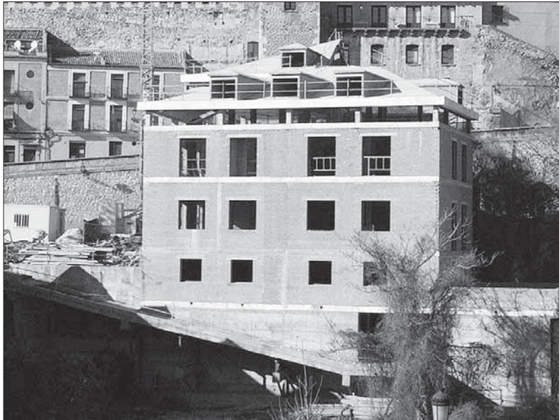
La rampa a lo largo de una fachada es una de las irregularidades argumentadas
