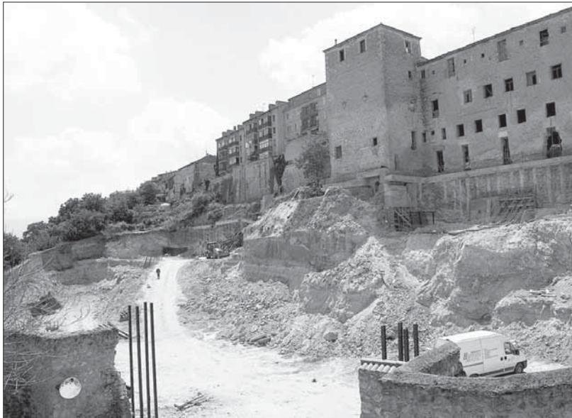
Imagen del desmonte efectuado en la huerta de Las Oblatas, para construir el aparcamiento JUAN MARTIN
