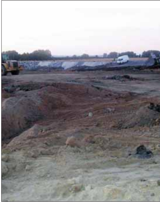
Instalaciones del vertedero provincial
