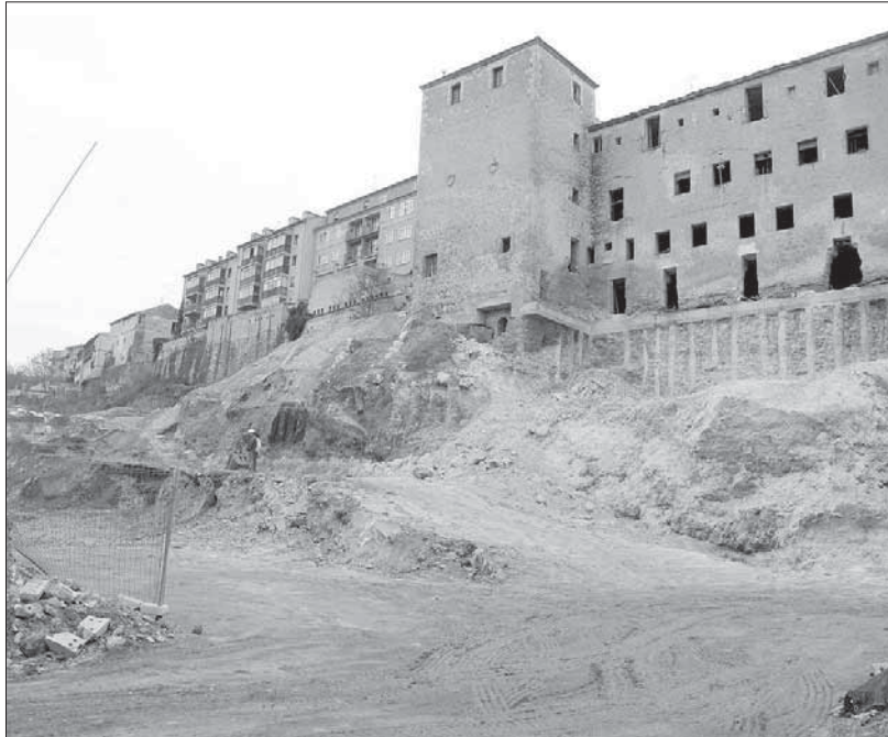
Las obras de construcción del aparcamiento han causado un importante desmonte
