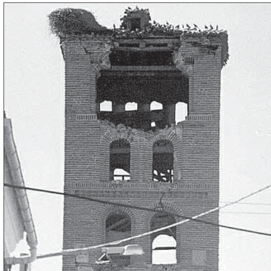
Estado en que quedó la iglesia al sufrir un derrumbe en 1998 F. D.
