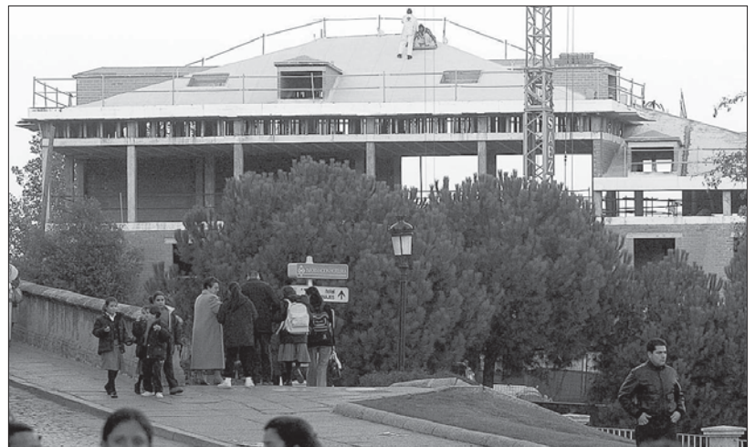
El informe de la Junta concluye que la obra no se ajusta al proyecto autorizado y se pasa de volumen J.M.
